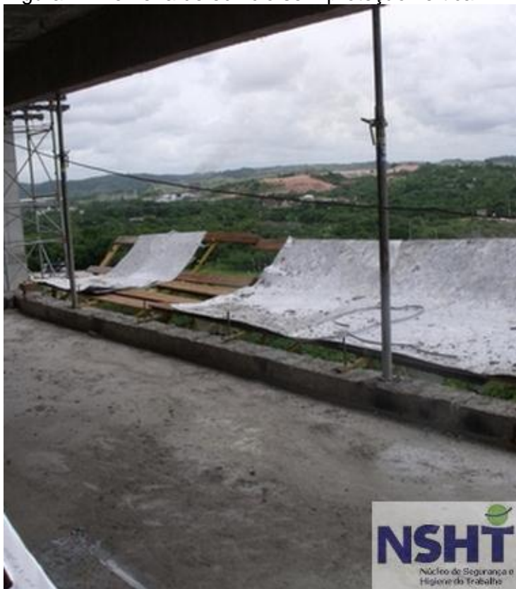
Figura 7 - Periferia de edifício sem proteção vertical
