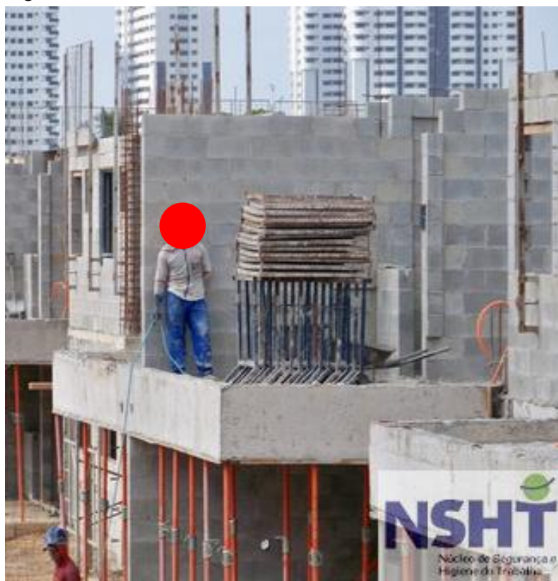
Figura 11 – Trabalhador em área de risco sem uso de cinto de segurança
