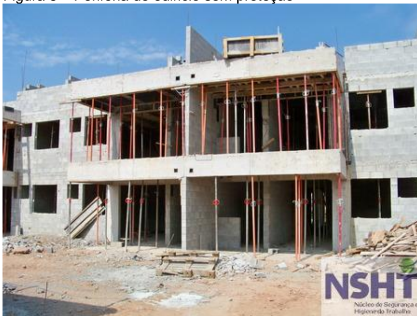
Figura 6 – Periferia de edifício sem proteção
