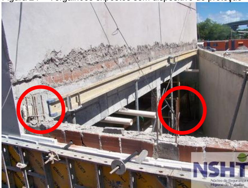
Figura 24 – Vergalhões expostos sem dispositivo de proteção
