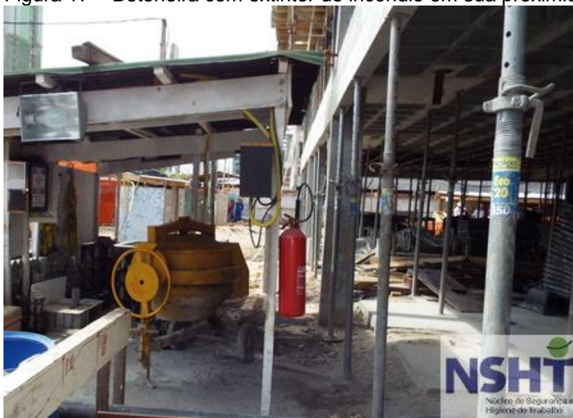
Figura 17 – Betoneira com extintor de incêndio em sua proximidade
