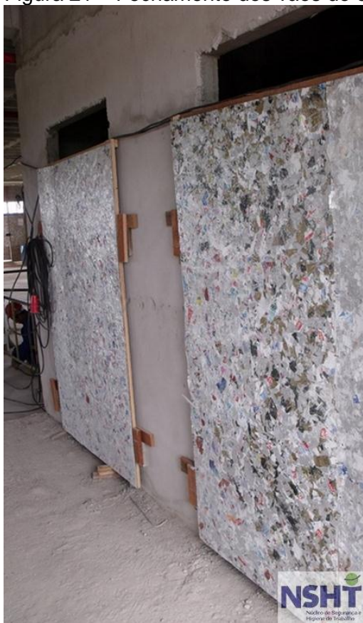
Figura 21 – Fechamento dos vãos do elevador com proteção fixa e resistente
