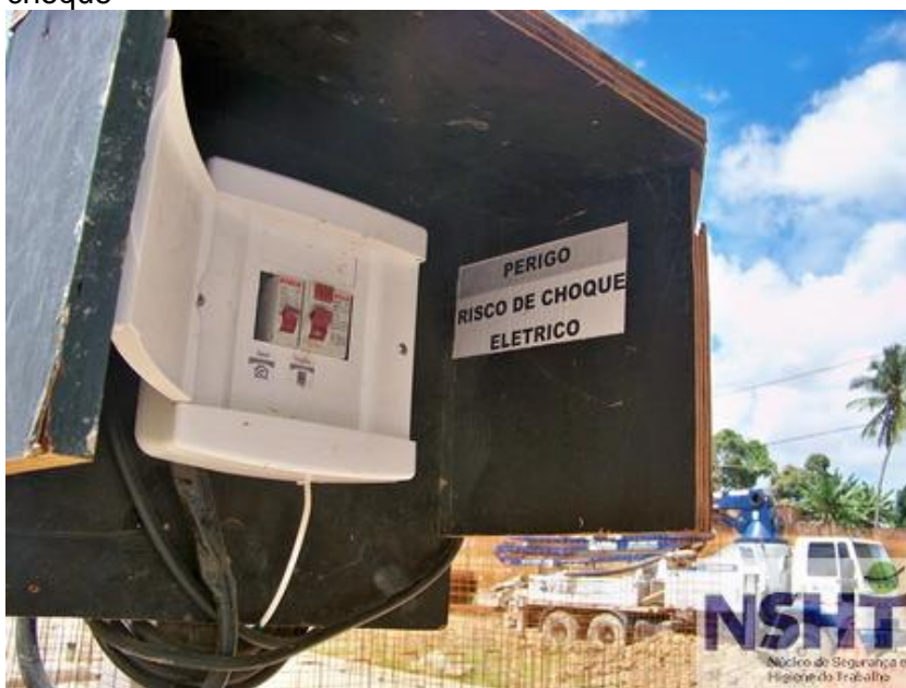
Figura 10 – Circuito elétrico protegido por caixa de PVC e sinalizado quanto ao risco de choque
