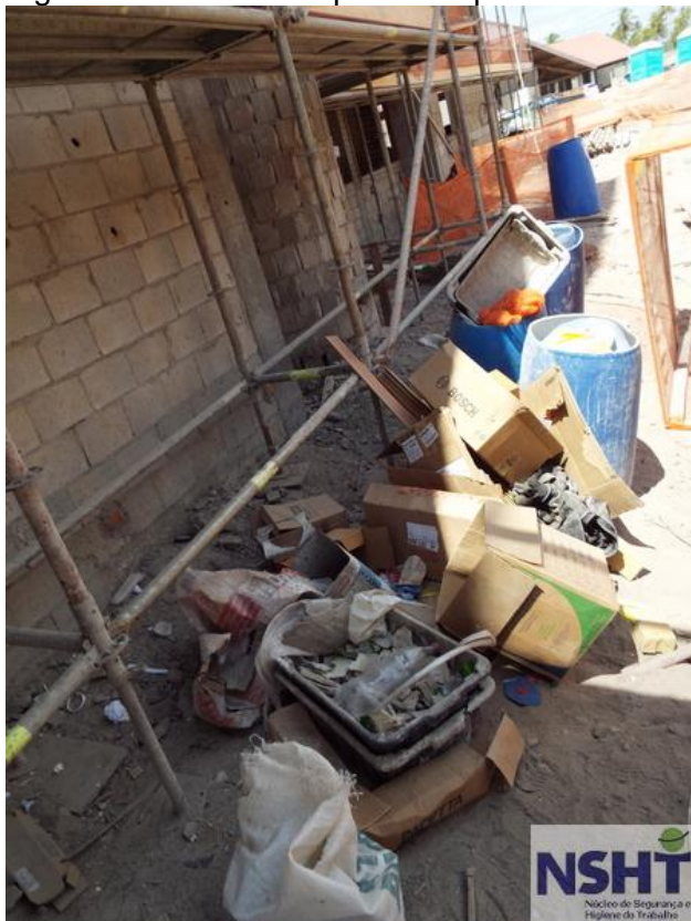
Figura 26 – Entulho espalhados por via de acesso do canteiro de obras
