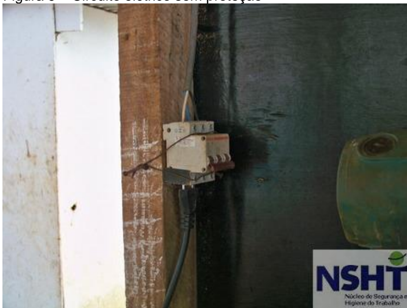
Figura 9 – Circuito elétrico sem proteção
