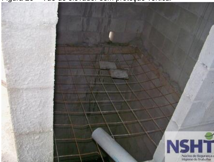
Figura 20 – Vão de elevador sem proteção vertical
