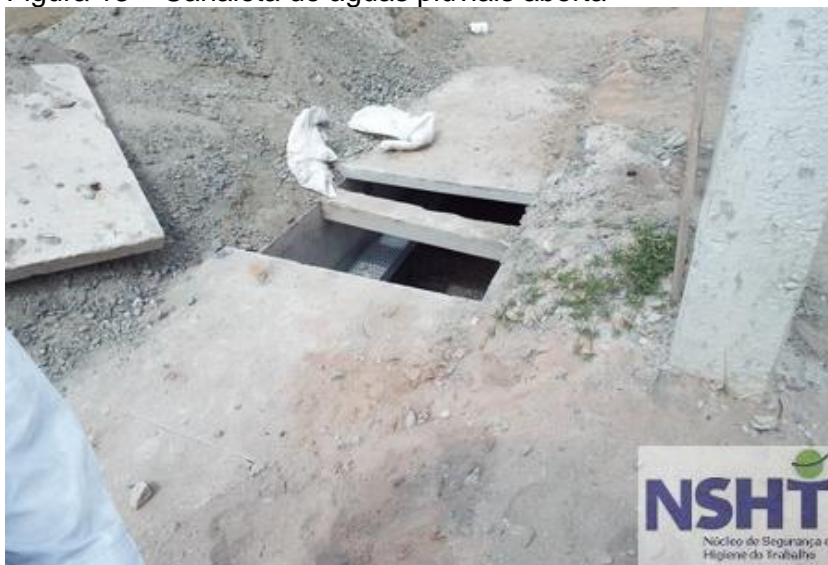
Figura 13 – Canaleta de águas pluviais aberta
