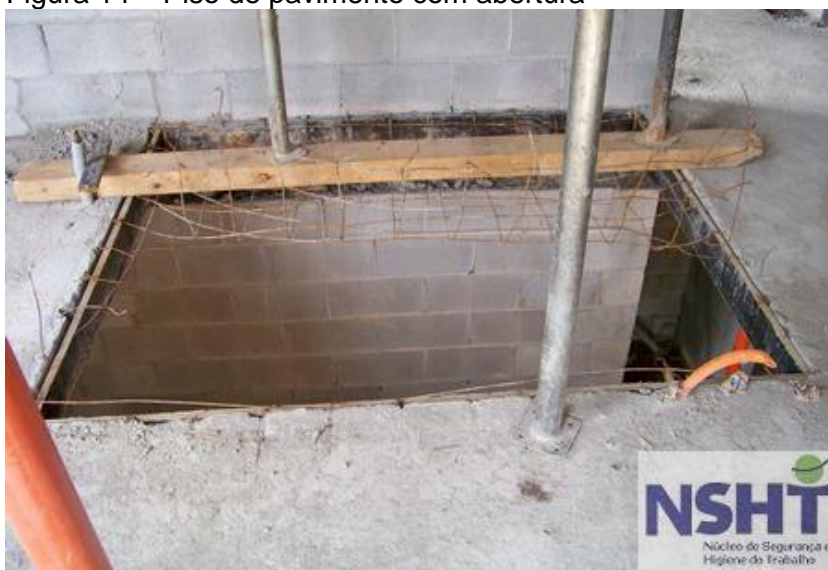
Figura 14 – Piso de pavimento com abertura
