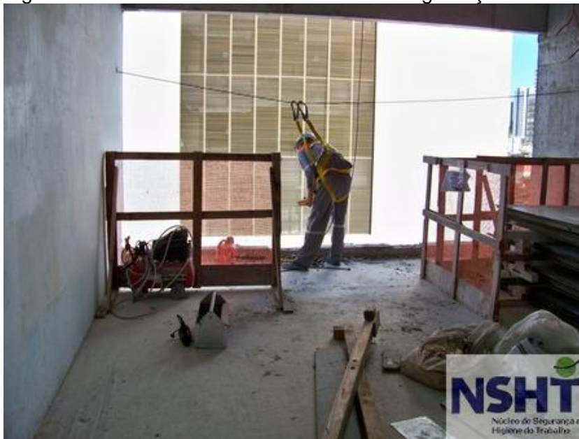
Figura 12 – Trabalhador utilizando cinto de segurança em atividade próximo à periferia
