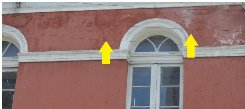
Figura 74 – Manchas de umidade acompanhadas de eflorescência, fachada norte do GP
