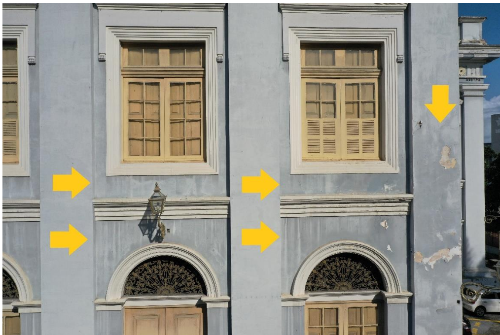
Figura 24 – Manchas de umidade, fachada oeste do PJJ
