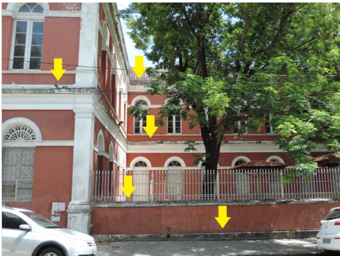
Figura 73 – Pontos de sujidade da fachada norte do GP
