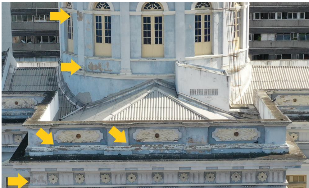
Figura 31 – Destacamento de pintura e destacamento de reboco, fachada sul do PjN
