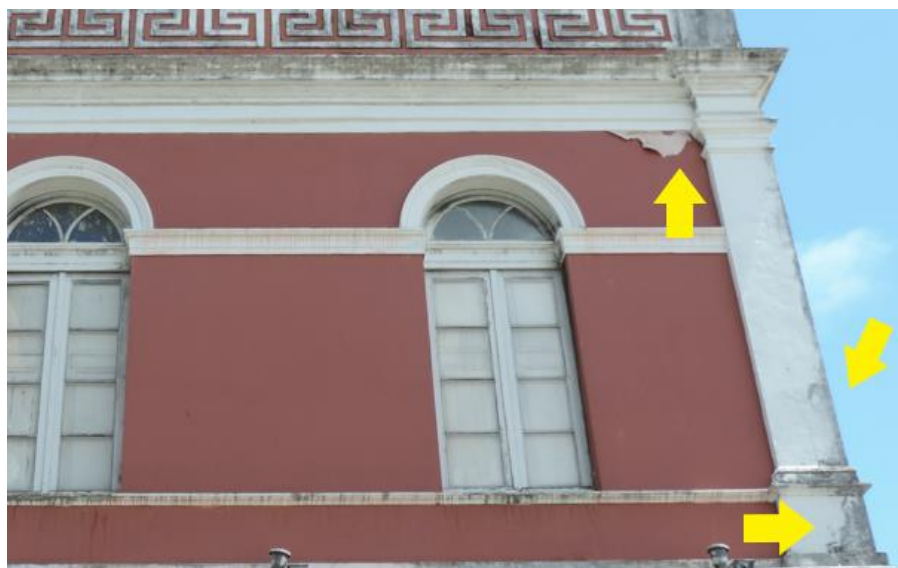
Figura 76 – Destacamentos de pintura na fachada norte do GP
