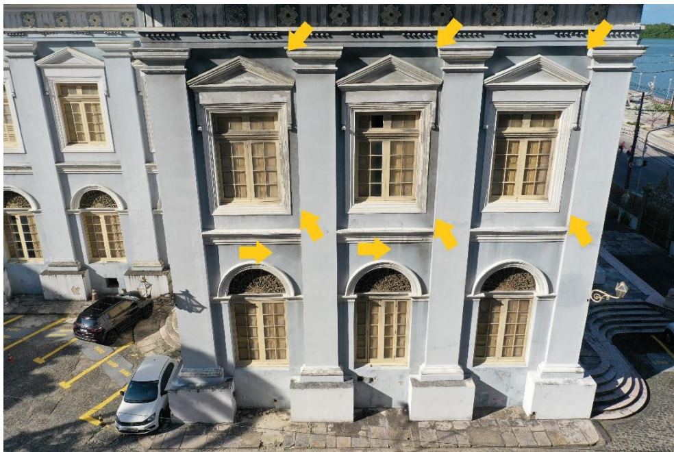
Figura 37 – Pontos de sujidade em torno das janelas, fachada norte do PJN
