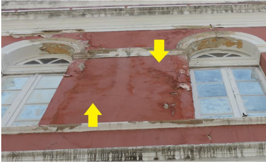
Figura 58 – Manchas de umidade na fachada oeste do GP
