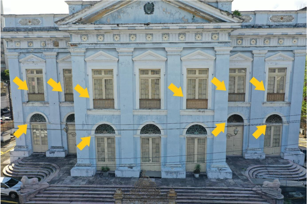
Figura 16 – Oxidação das grades das janelas e cercaduras das portas, fachada leste do PJN
