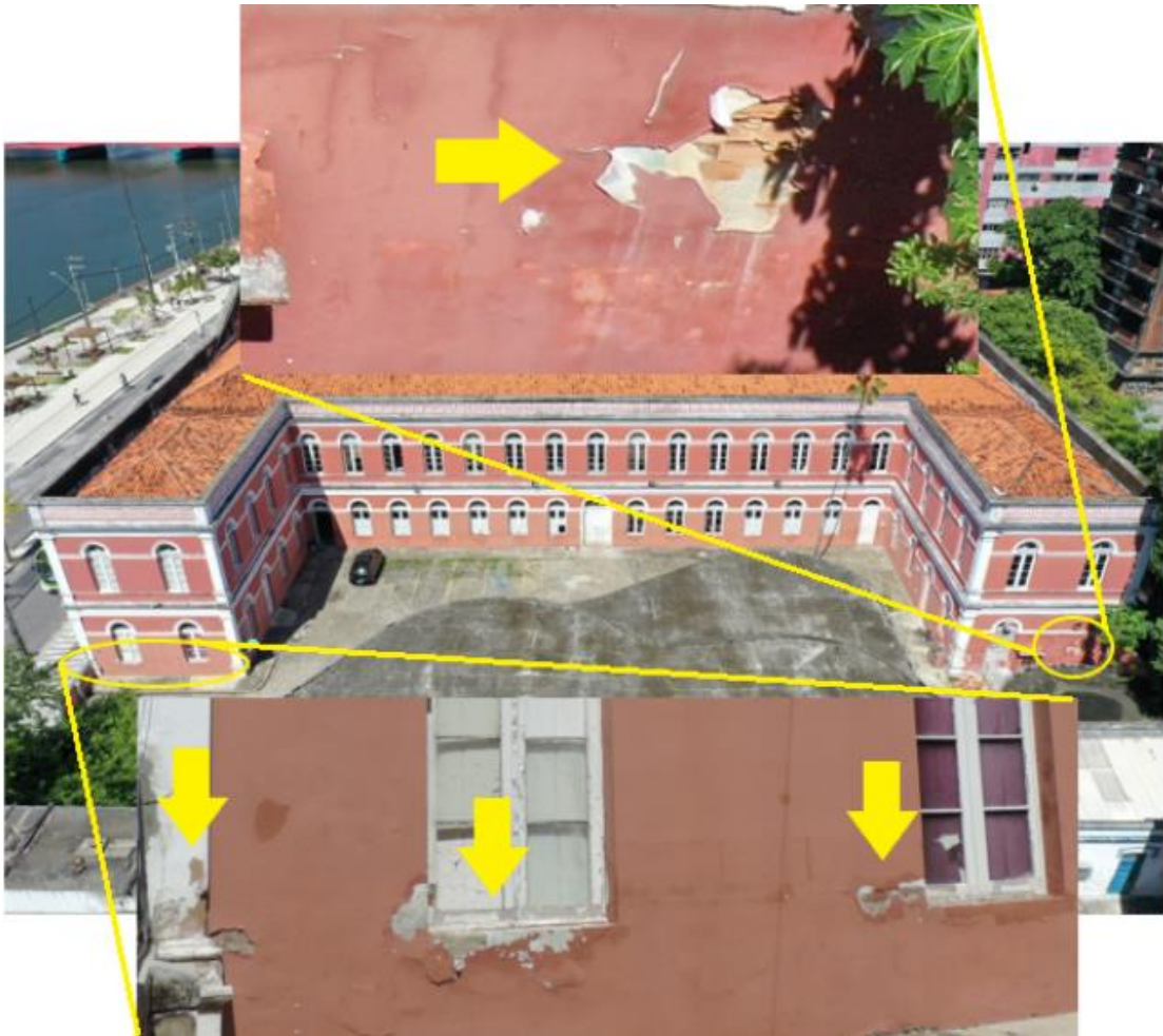
Figura 67 – Destacamentos de pintura e reboco na fachada sul do GP
