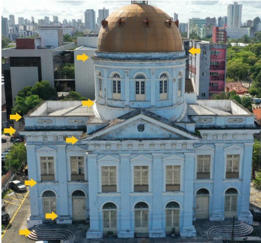
Figura 12 – Pontos de sujidade, fachada leste do PJN
