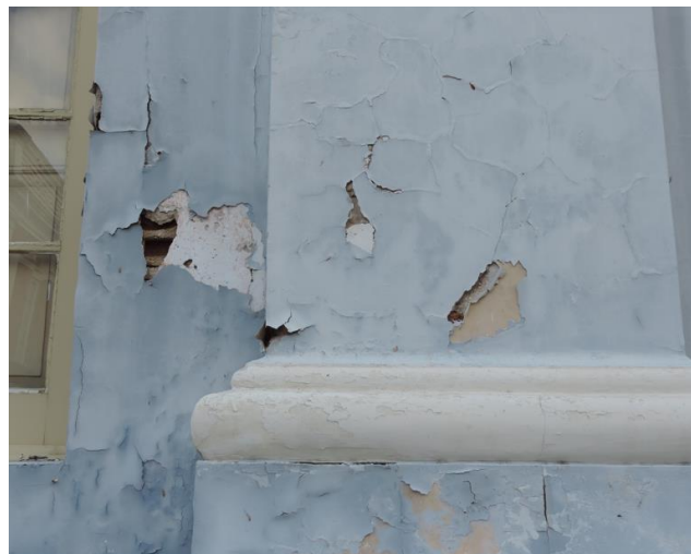
Figura 33 – Pontos de fissuração, fachada sul o PJN
