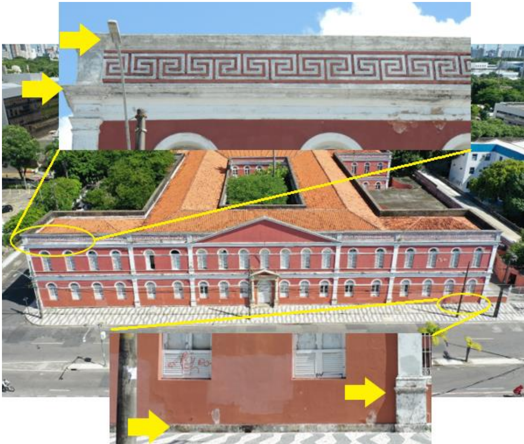
Figura 46 – Pontos de sujidade, fachada leste do GP
