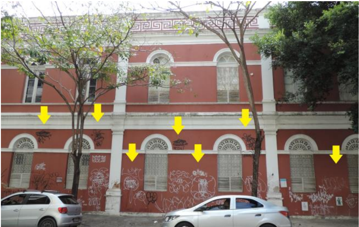
Figura 60 – Atos de vandalismo na fachada oeste do GP
