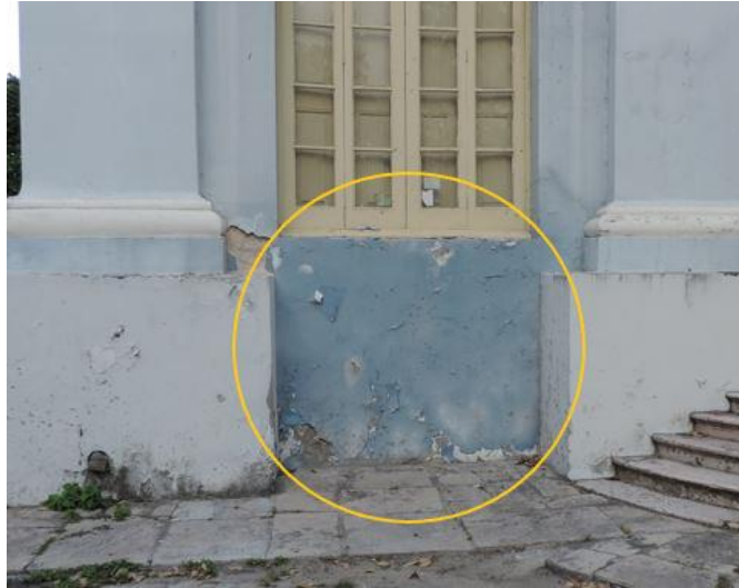
Figura 25 – Mancha de umidade abaixo de esquadria, fachada oeste do PJN
