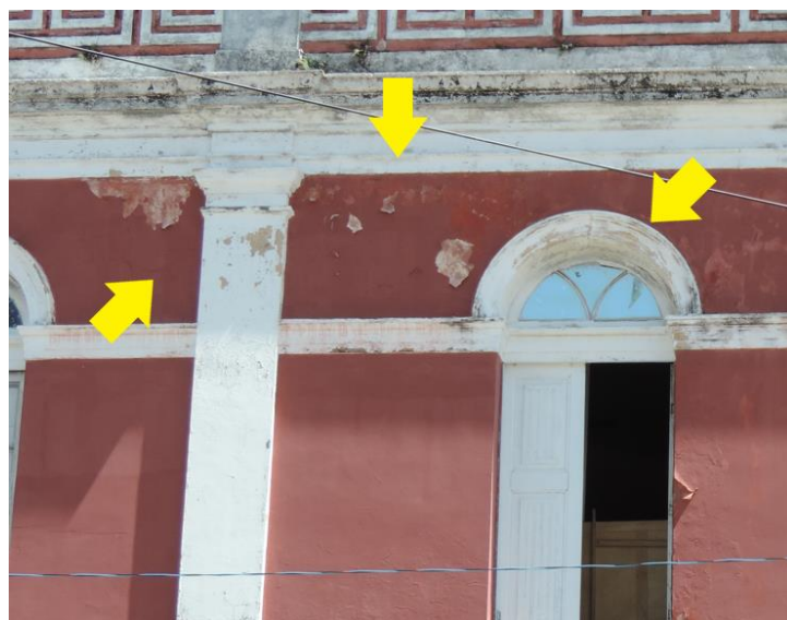
Figura 48 – Pontos de destacamento de pintura, fachada leste do GP
