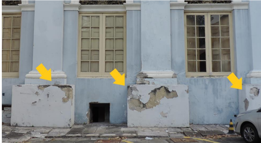
Figura 32 – Destacamento de reboco em bases de colunas, fachada sul o PJN
