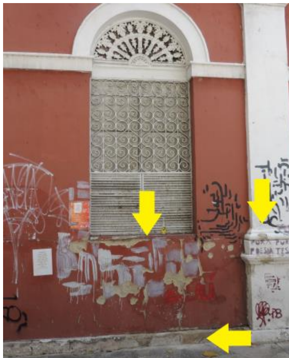
Figura 59 – Destacamento de pintura, reboco e degradação na base do GP
