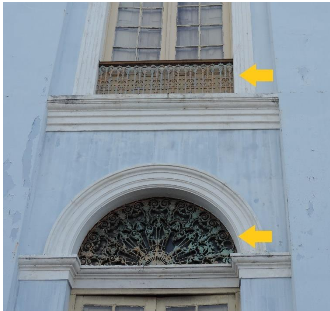
Figura 17 – Pontos de oxidação, fachada leste do PJN
