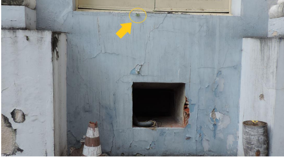
Figura 39 – Destacamento de pintura e reboco, fissuras e vegetação (circulado em amarelo) localizados abaixo de uma das janelas, fachada norte do PjN
