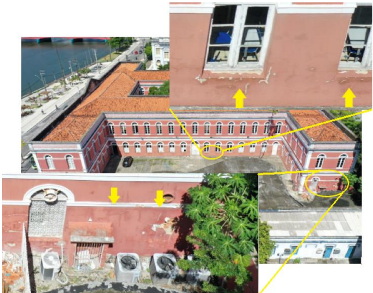
Figura 66 – Manchas de umidade na fachada sul do GP
