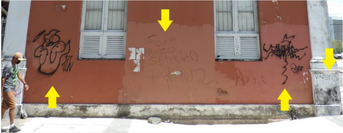
Figura 75 – Atos de vandalismo na fachada norte do GP
