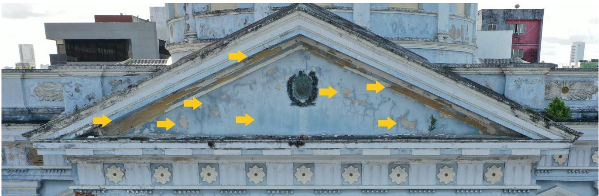
Figura 18 – Destacamento de reboco, manchas de umidade e fissuras no frontão triangular do PJN
