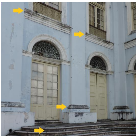
Figura 13 – Pontos de sujidade, parte da fachada leste do PJN
