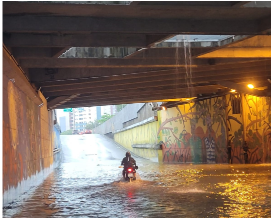
Figura 48 - Imagem do interior do Túnel com a queda de água que escorre da calha
