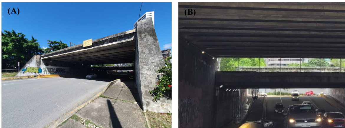
Figura 13 – Estruturas do Túnel Chico Science: a sua entrada (A) e a interligação com a Ponte Prof. Lima de Castilho (B).
