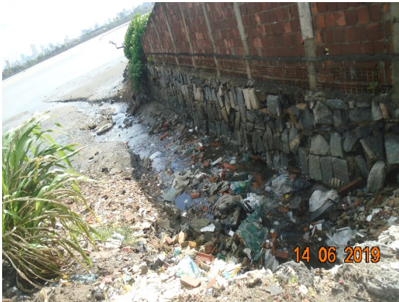
Figura 29 - Jusante da Avenida Antônio de Góes na Rua Cacilda Jolanda – Pina
