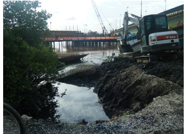
Figura 30 - Jusante da Galeria da Avenida República Árabe Unida
