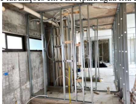
Figura 74 - Utilização de tubulações em PEX (para água fria e quente e gás de cozinha).
