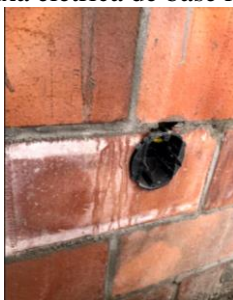
Figura 49 - Caixa elétrica de base redonda.
