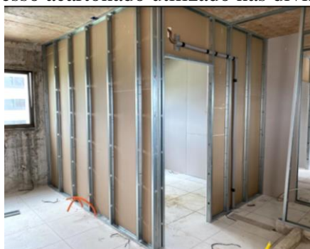
Figura 73 - Gesso acartonado utilizado nas divisórias internas.
