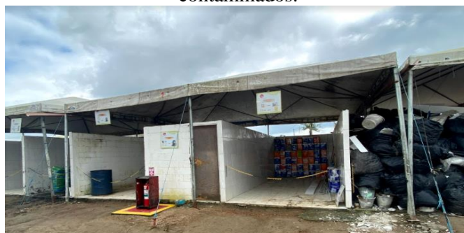
Figura 62 - Baias fixas para resíduos de madeiras, químicos, plástico, papelão e resíduos contaminados.
