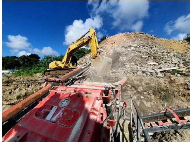
Figura 5 – Resíduos de construção e demolição localizados na empresa de reciclagem.
