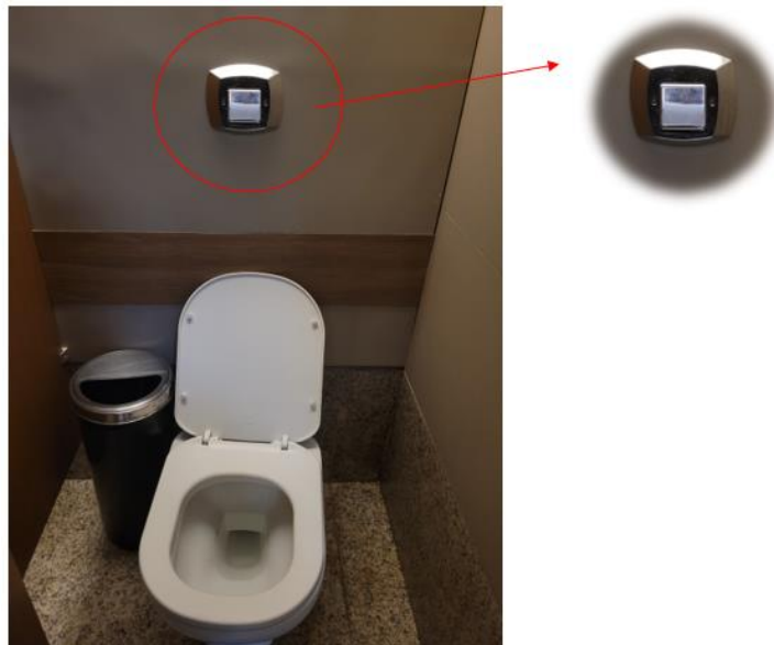
Figura 14 – Bacia sanitária com acionamento simples – Banheiro B.Lém
