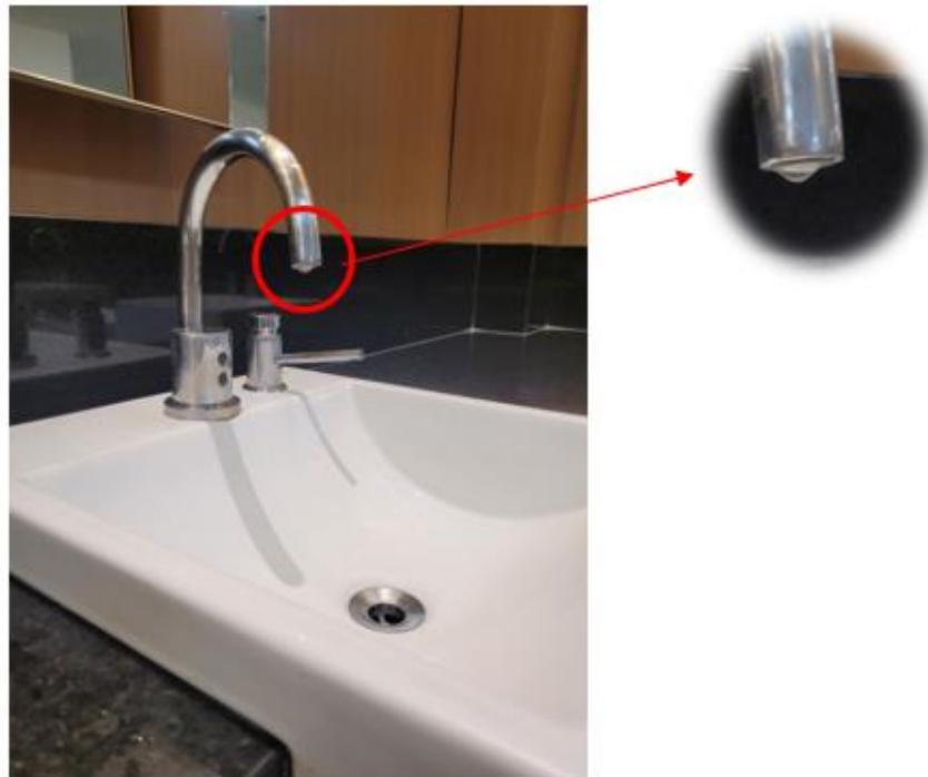
Figura 24 – Torneira – Banheiro: B.Lém
