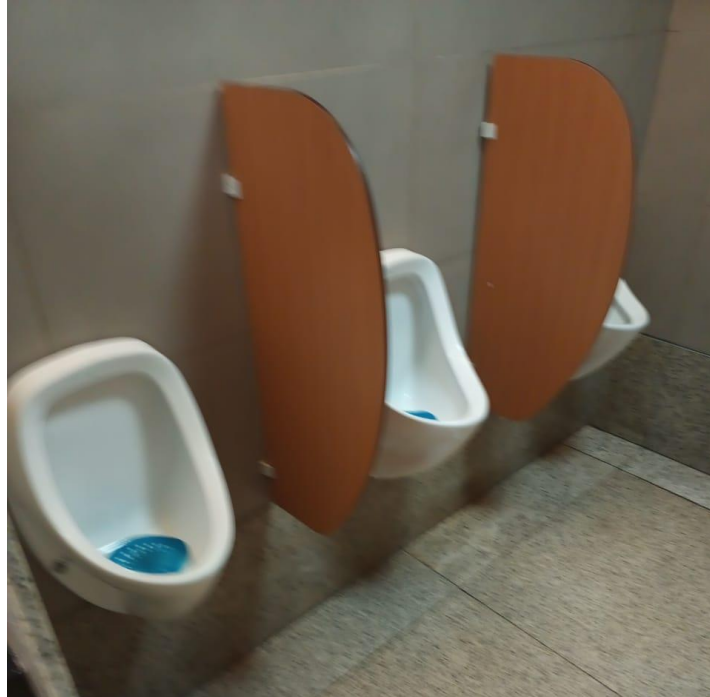
Figura 19 – Estado de Conservação dos Mictórios do banheiro ao lado da Nagem
