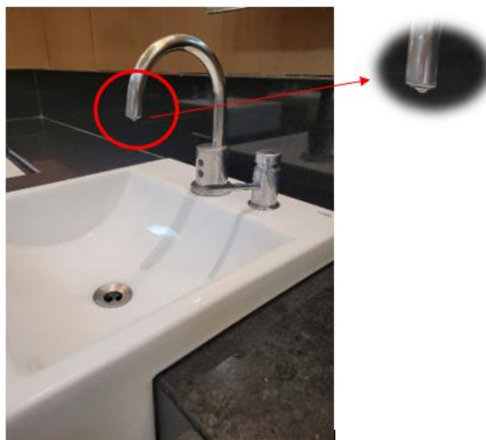
Figura 22 – Torneira – Banheiro San Paolo
