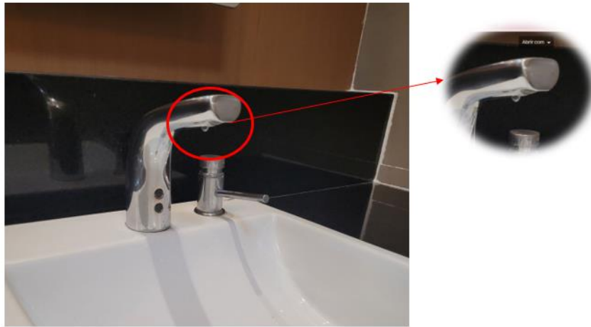
Figura 23 – Torneira – Banheiro Nagem
