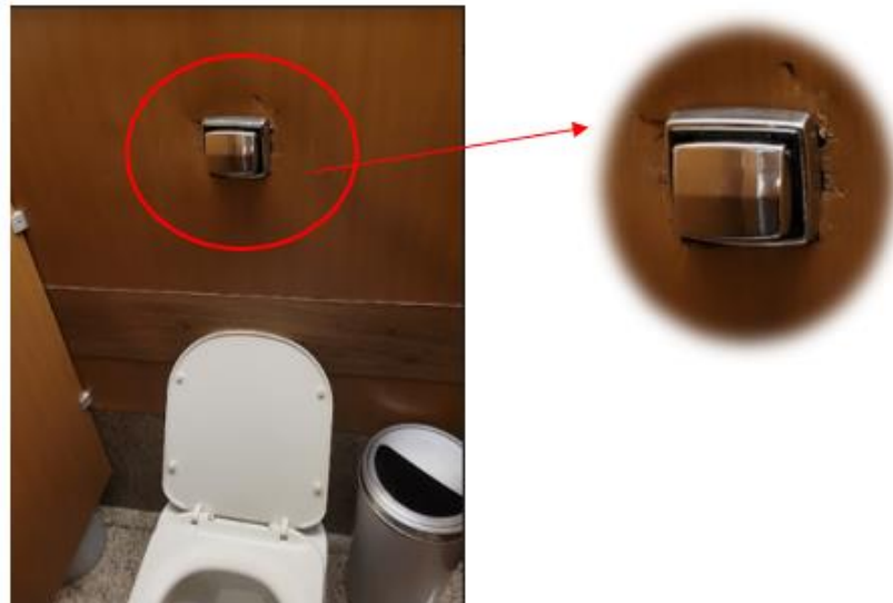
Figura 26 – Quebra ao redor do acionamento da descarga
