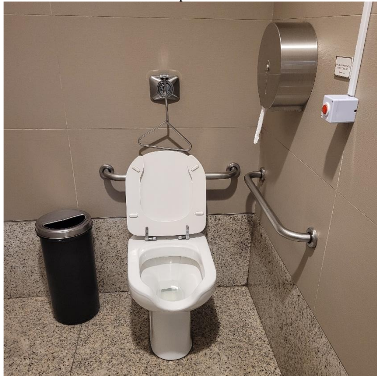
Figura 21 – Estado de Conservação da Bacia Sanitária do Banheiro para Pessoas com Necessidades Especiais
