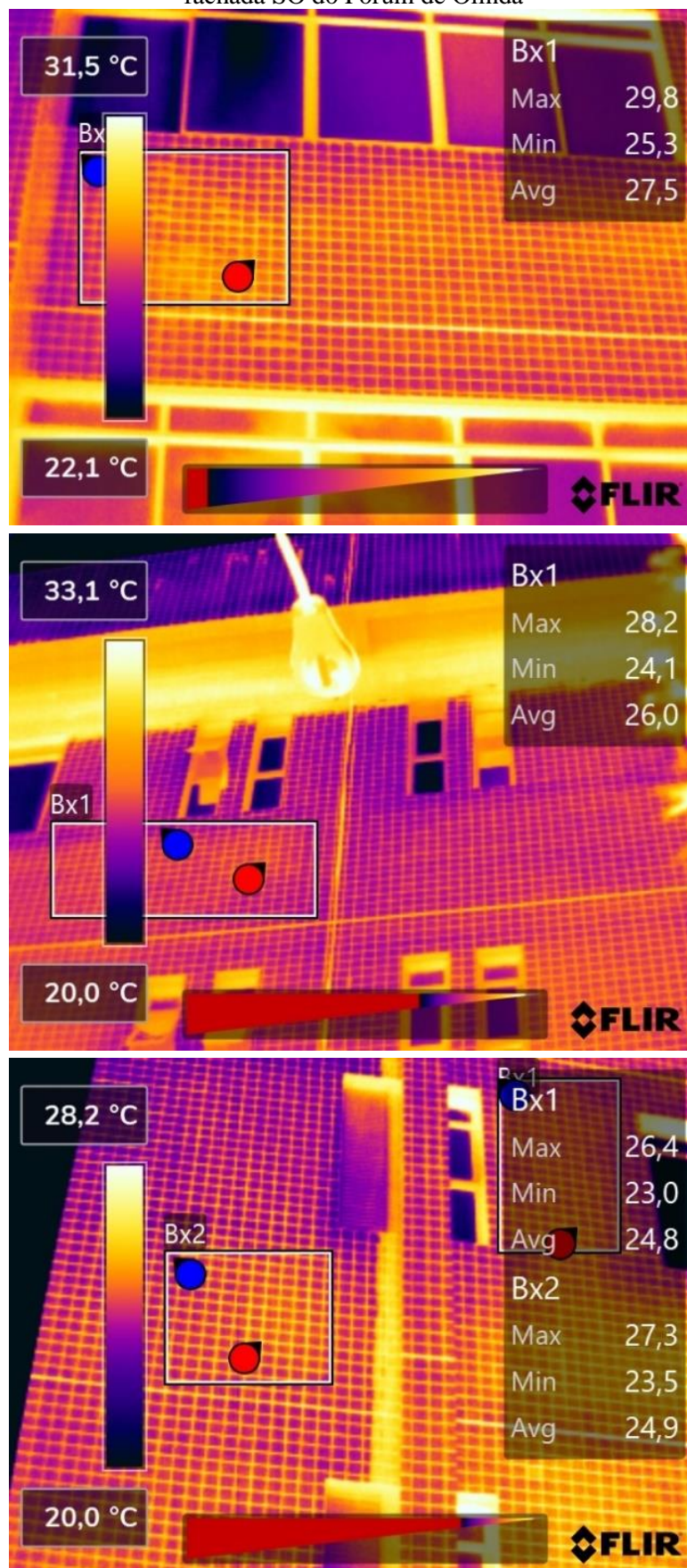
Figura 51 – Detecção de áreas suspeitas de descolamentos em fase inicial nos revestimentos da fachada SO do Fórum de Olinda
