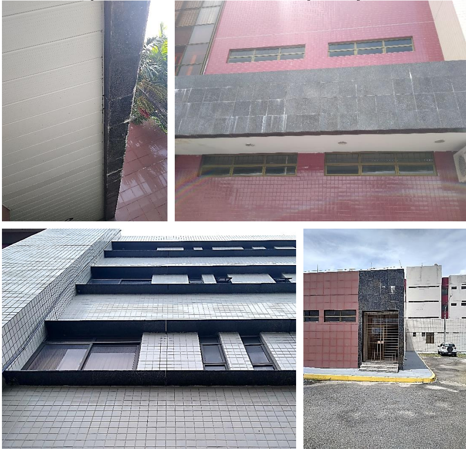
Figura 32 – Vistas parciais dos trechos em revestimento pétreo das fachadas SE, NE, SO e NO, apresentando e florescência e deterioração do rejunte
