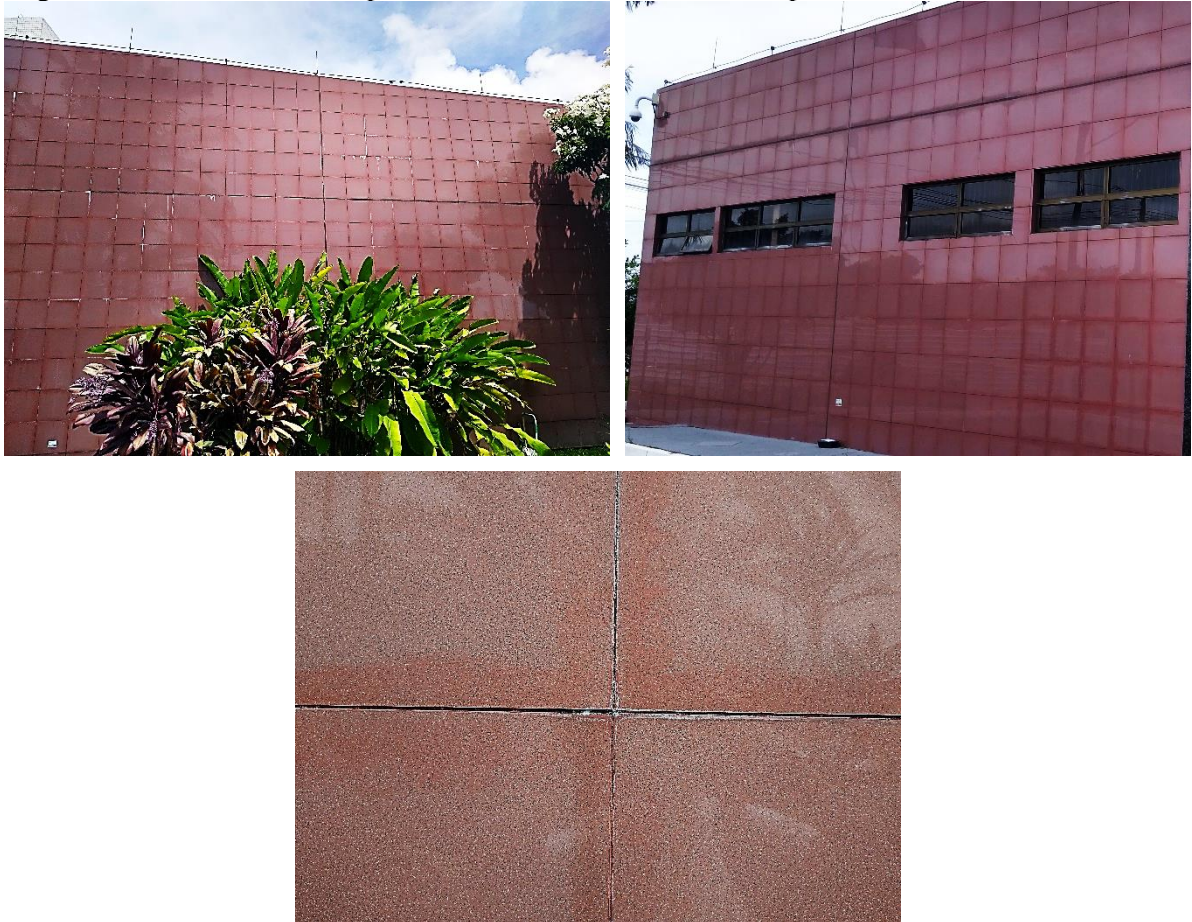
Figura 31 – Revestimento em porcelanato das fachadas SE e NE apresentando manchas escurecidas
