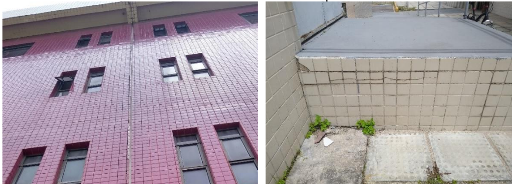
Figura 33 – Revestimentos cerâmicos das fachadas SO e NE apresentando descolamento e fissuração
