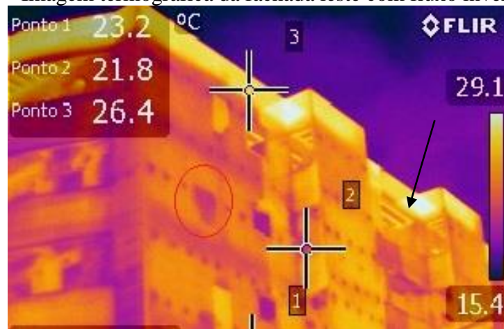
Figura 41 – Imagem termográfica da fachada leste com fluxo inverso de calor
