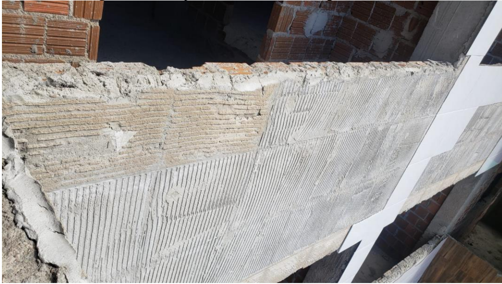
Figura 42 – Rompimento na camada da argamassa colante
