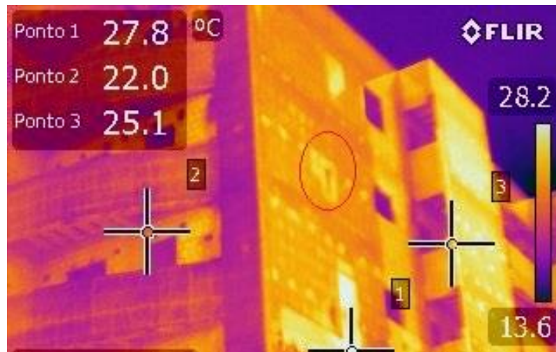
Figura 37 – Imagem termográfica do descolamento da fachada leste
