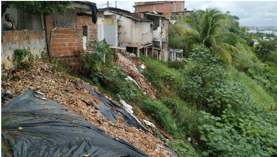
Figura 3 - Ações antrópicas em encosta: Rua Alto do Olho d'água-Macaxeira-Recife-PE
