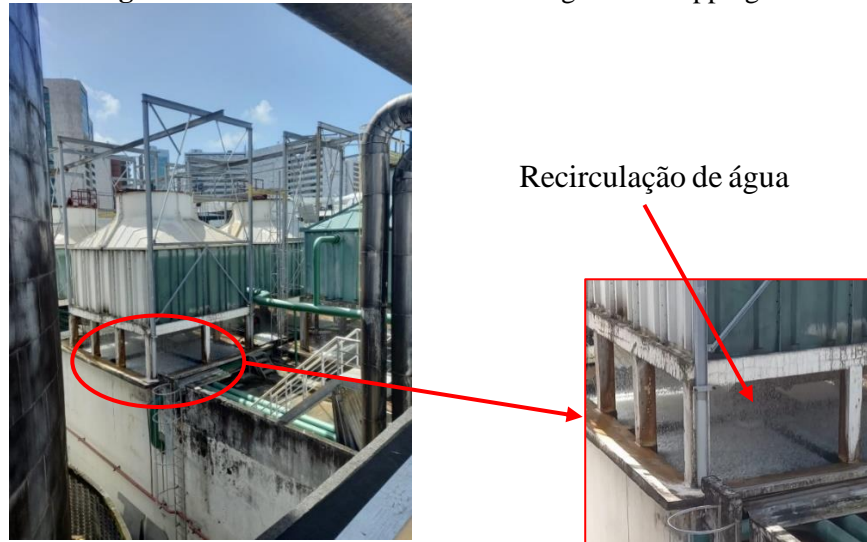
Figura 26 - Torres de resfriamento de água do Shopping Center
