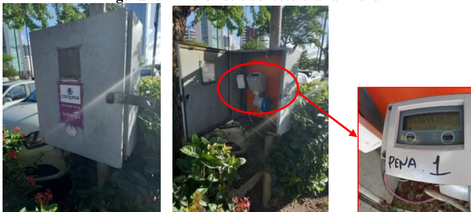
Figura 19 - Hidrômetro concessionária - Pena 1
