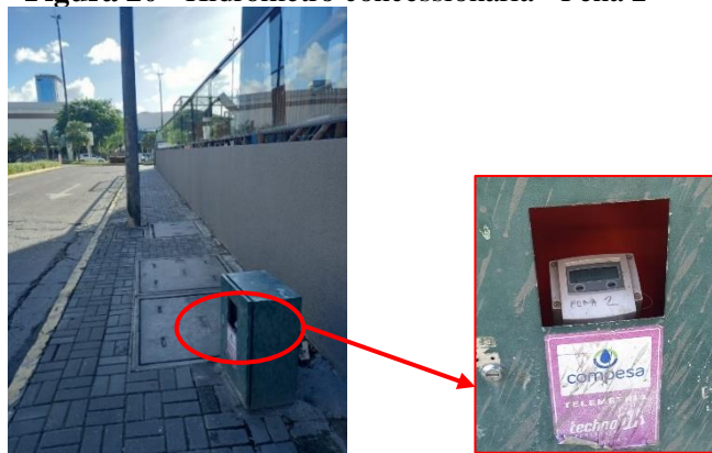
Figura 20 - Hidrômetro concessionária - Pena 2
