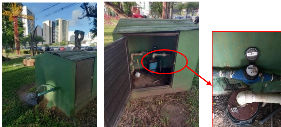
Figura 21 – Hidrômetro do poço
