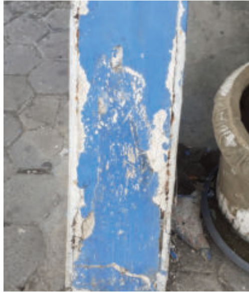
Figura 42 – Destacamento da pintura e fissuras verticais na fachada frontal do bloco B
