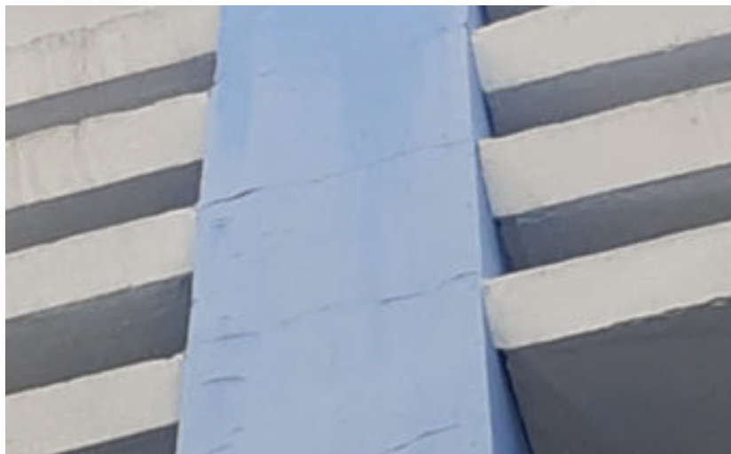
Figura 45 – Fissuras horizontais na fachada frontal do bloco B
