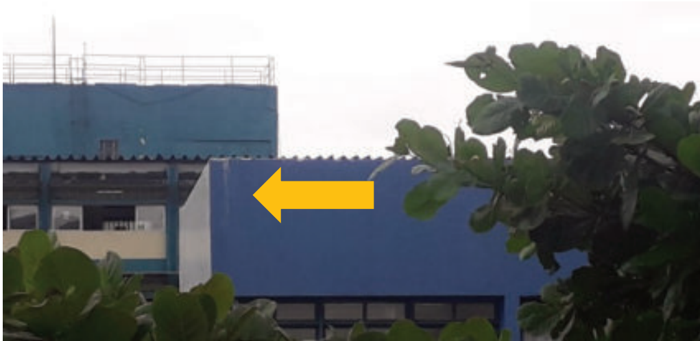
Figura 69 – Eflorescência na fachada frontal do bloco C
