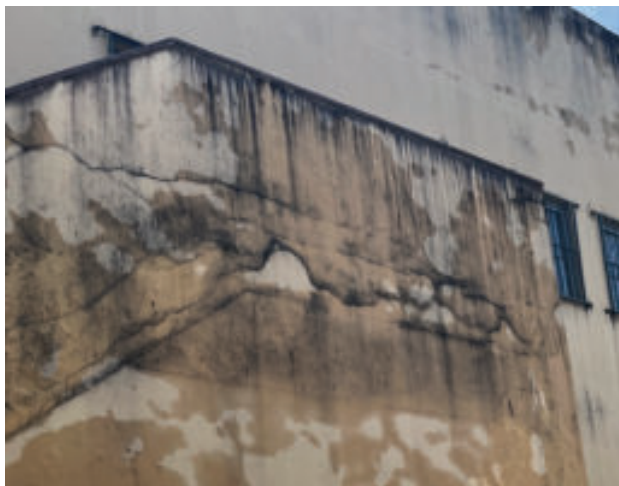
Figura 192 – Fissura horizontal na fachada posterior do bloco H
