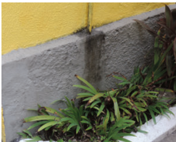
Figura 118 – Sujidade na fachada lateral esquerda do bloco F
