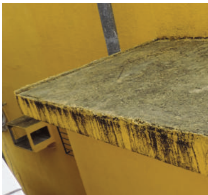
Figura 123 – Sujidade na fachada posterior do bloco F
