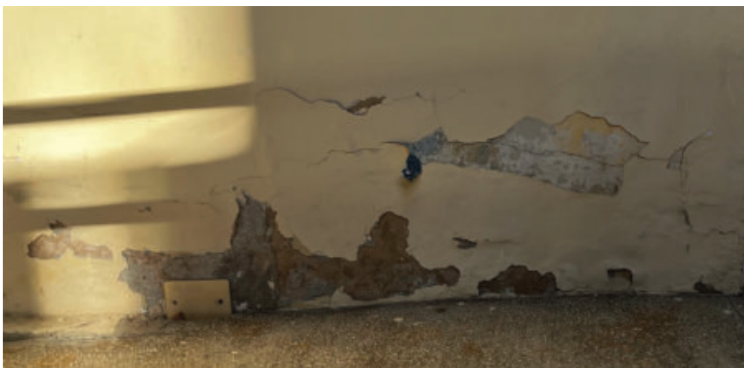
Figura 87 – Destacamento da pintura na fachada frontal do bloco D
