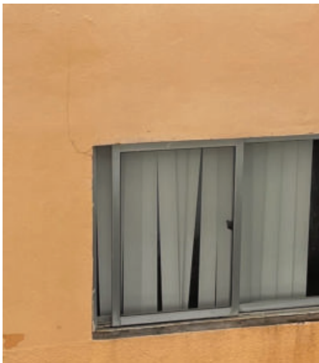
Figura 157 – Fissura vertical na fachada posterior do bloco G
