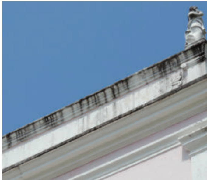
Figura 32 – Sujidade na fachada lateral esquerda do bloco A
