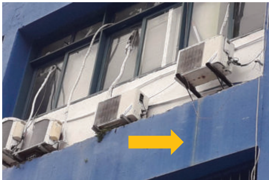
Figura 80 – Sujidade na fachada posterior do bloco C
