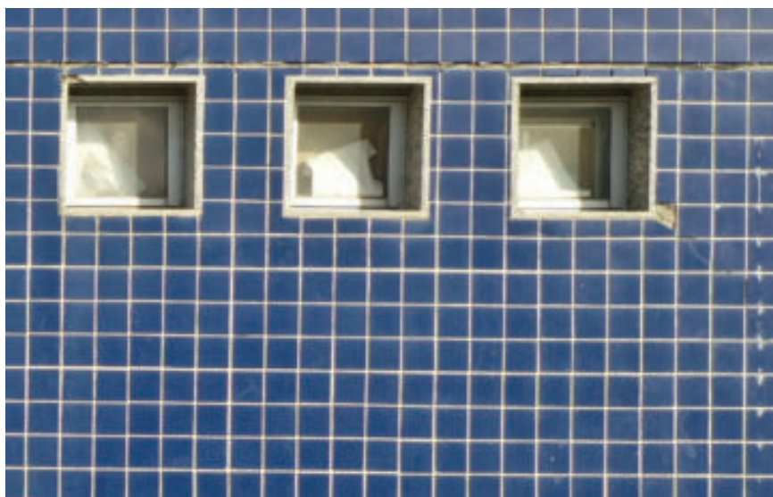
Figura 201 – Fissuras de 45° na fachada frontal dos blocos I e K
