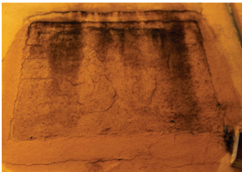
Figura 176 – Fissura aleatória e sujidade na fachada lateral direita do bloco H
