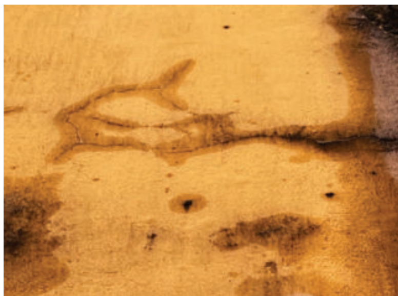
Figura 175 – Fissura aleatória na fachada lateral direita do bloco H
