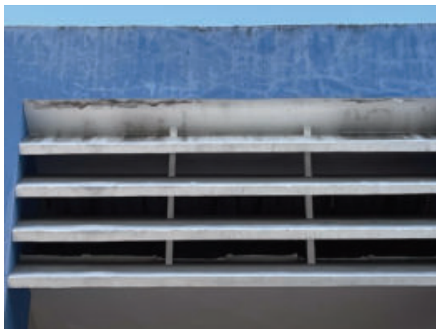
Figura 43 – Eflorescência na fachada frontal do bloco B
