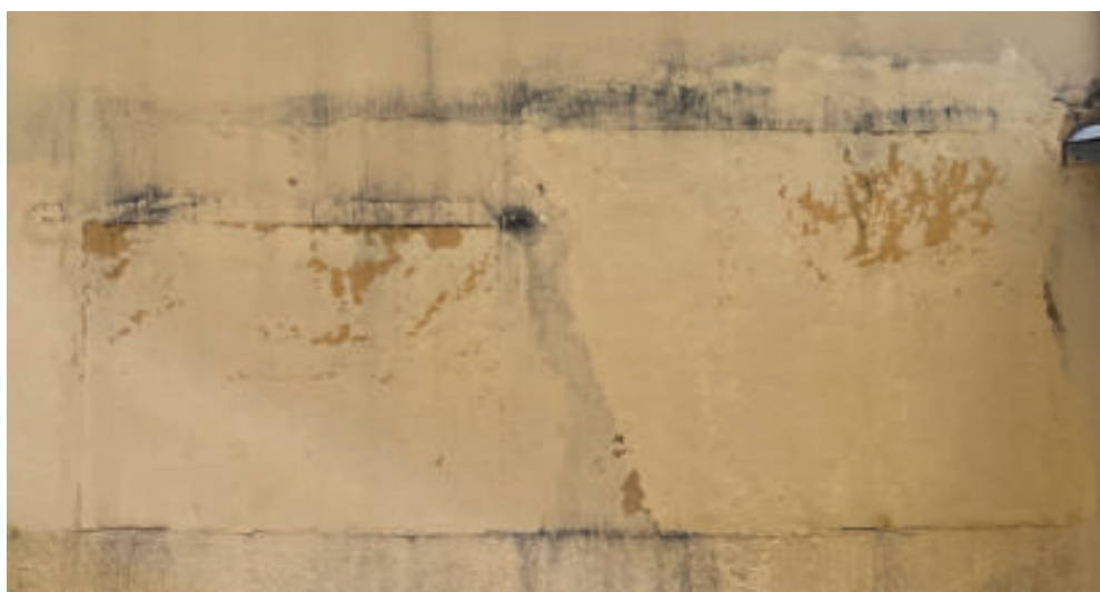
Figura 186 – Fissura, sujidade e destacamento da pintura na fachada posterior do bloco H
