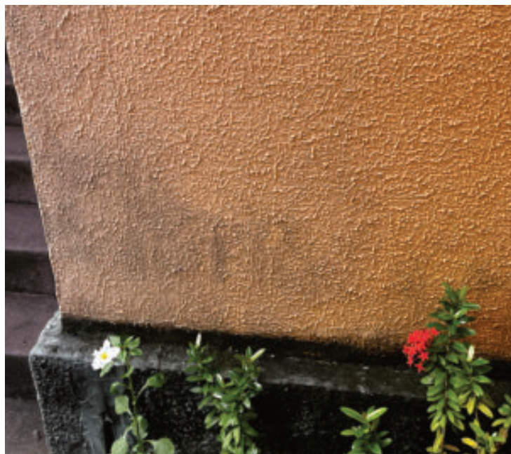
Figura 149 – Sujidade na fachada lateral esquerda do bloco G
