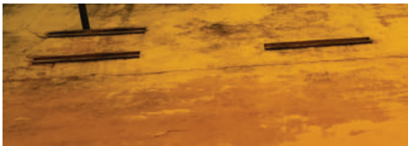
Figura 140 – Fissura horizontal que percorre todo o comprimento da fachada lateral do bloco G
