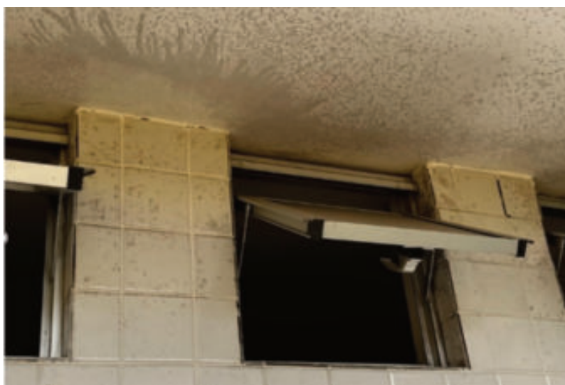
Figura 204 – Mofo no terceiro pavimento da fachada frontal dos blocos I e K
