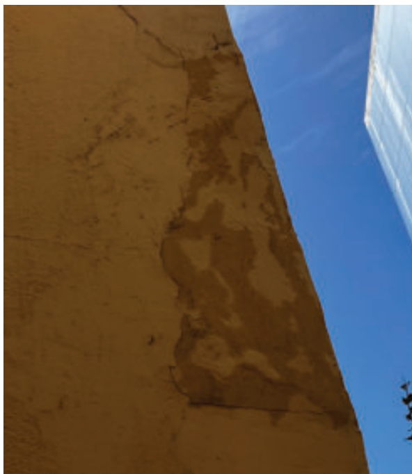
Figura 177 – Fissura sem direção definida na fachada lateral direita do bloco H
