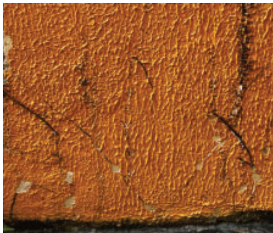
Figura 145 – Destacamento da pintura na fachada lateral esquerda do bloco G
