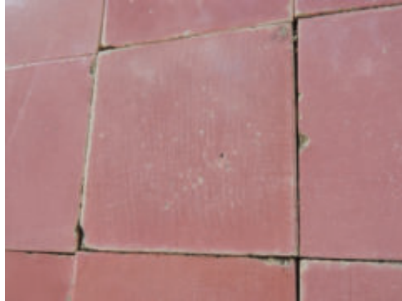
Figura 17 – Gretamento na fachada frontal do bloco A
