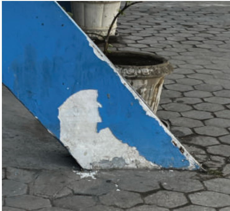
Figura 56 – Destacamento da pintura na fachada lateral esquerda do bloco B
