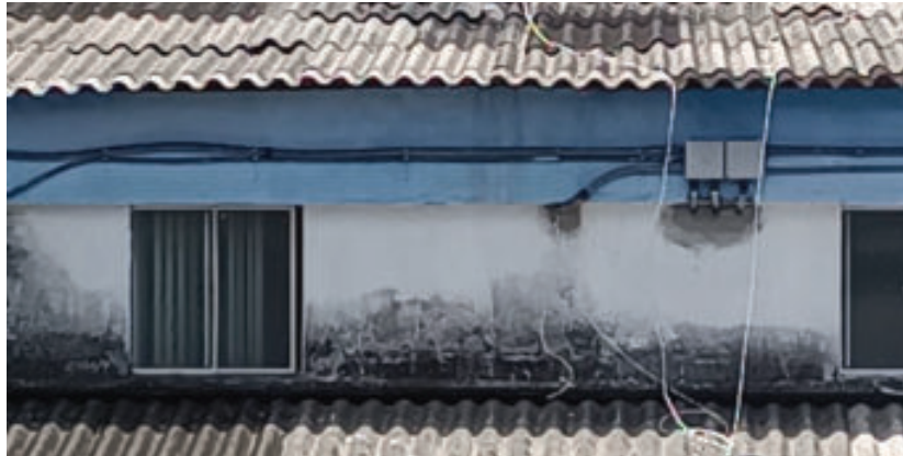
Figura 60 – Sujidade na fachada posterior do bloco B
