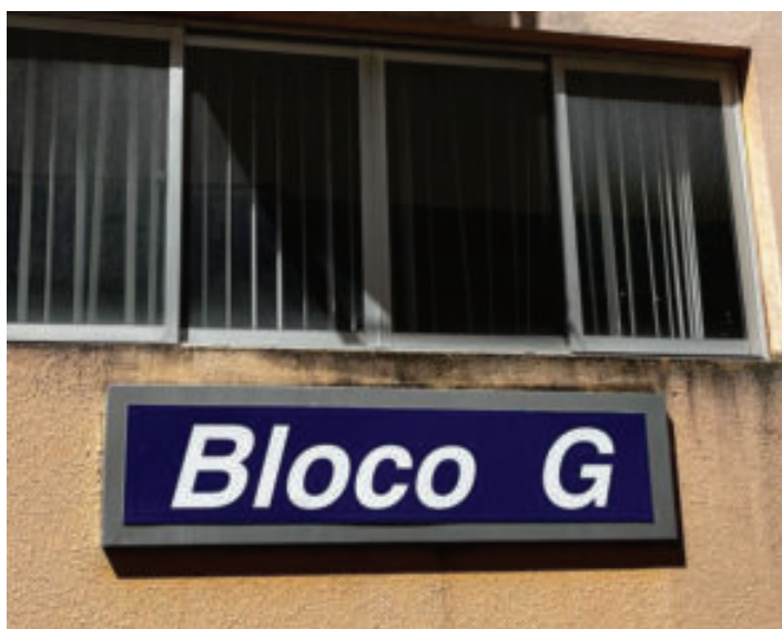
Figura 130 – Sujidade entre placa e janela da fachada frontal do bloco G
