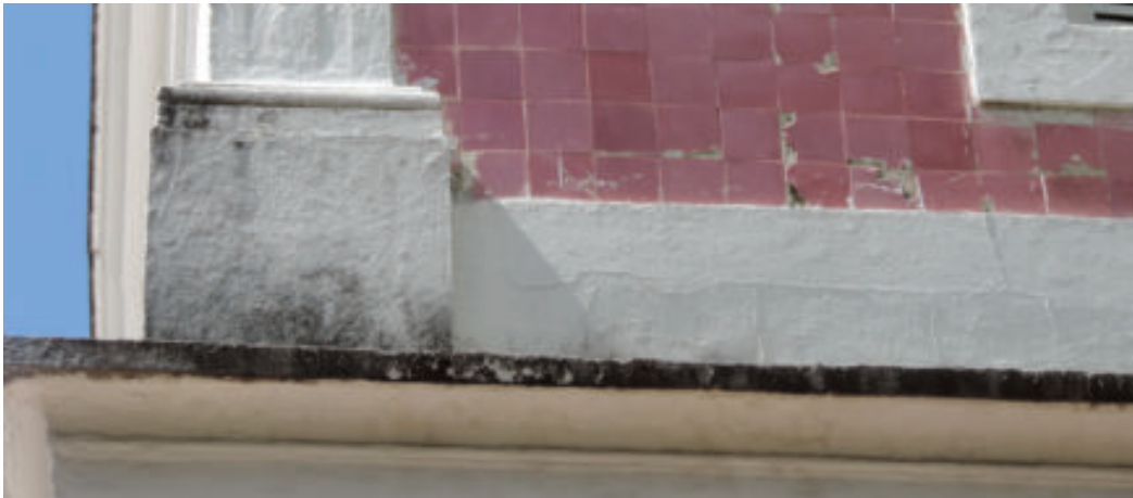
Figura 19 – Sujidade na fachada frontal do bloco A
