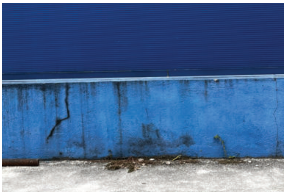
Figura 199 – Sujidade e fissuras na base da caixa do elevador da fachada frontal dos blocos I e K
