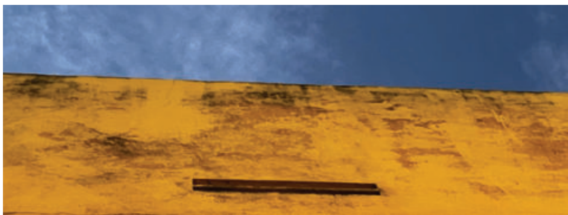
Figura 136 – Sujidade na parte superior da fachada lateral direita do bloco G
