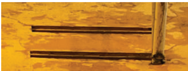
Figura 142 – Fissura 45° em abertura na fachada lateral direita do bloco G
