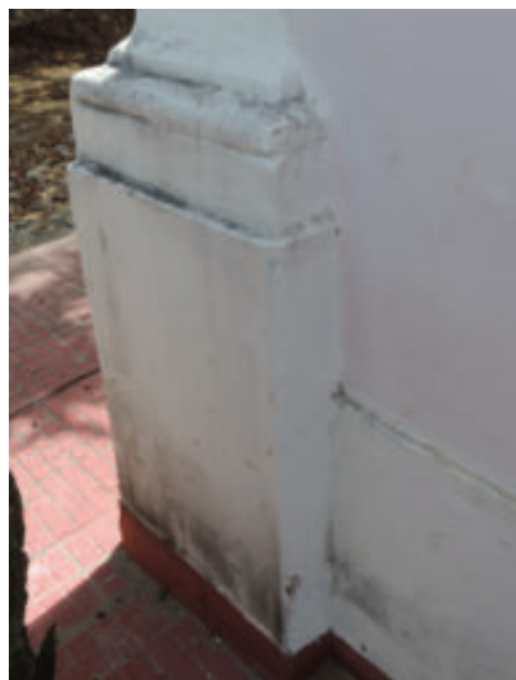
Figura 24 – Sujidade na fachada lateral direita do bloco A
