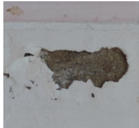
Figura 26 – Estufamento, destacamento da pintura e desagregamento da argamassa
