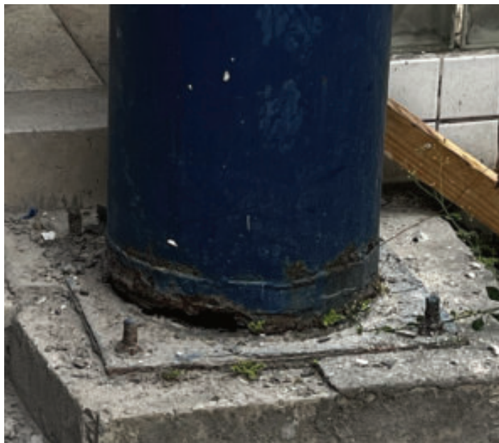
Figura 203 – Corrosão no pilar da fachada frontal dos blocos I e K
