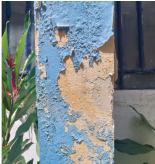
Figura 61 – Destacamento de pintura na fachada posterior do bloco B
