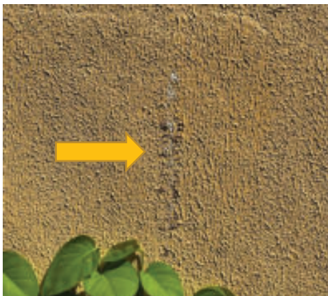
Figura 163 – Destacamento da pintura
