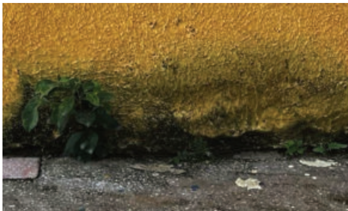
Figura 161 – Vegetação no piso da fachada frontal do bloco H
