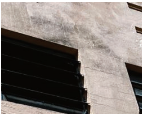
Figura 129 – Sujidade na parte superior de uma janela da fachada frontal do bloco G
