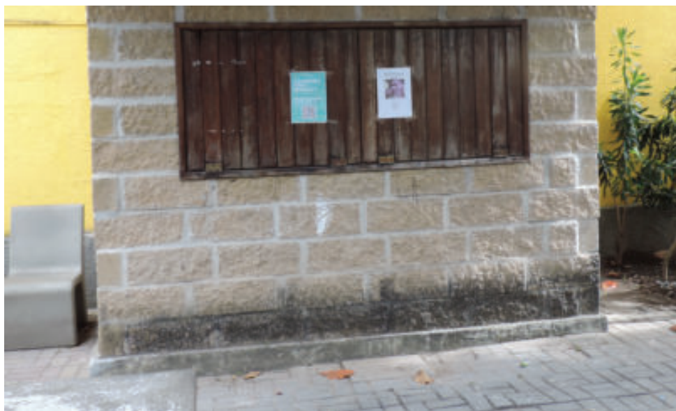
Figura 114 – Sujidade na fachada lateral direita do bloco F
