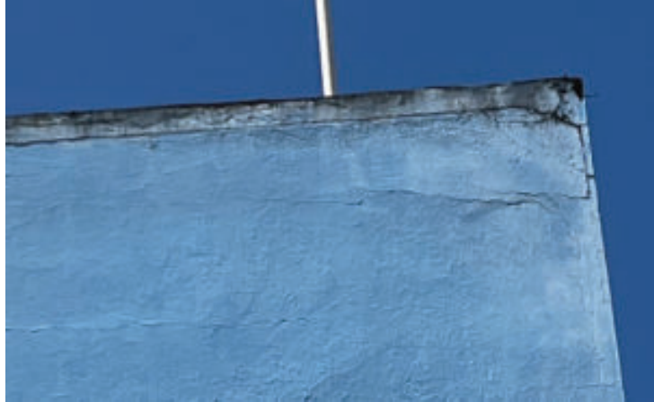
Figura 55 – Sujidade na fachada lateral esquerda do bloco B
