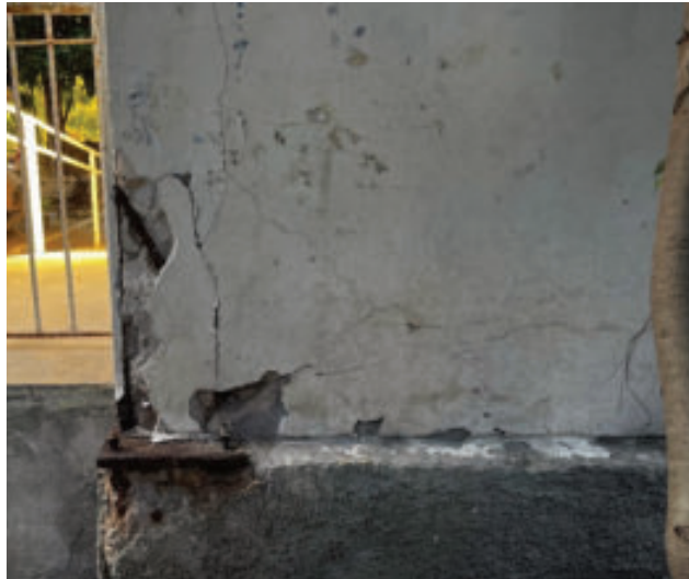
Figura 92 – Corrosão no pilar esquerdo, fissuras e trincas da fachada lateral direita do bloco D
