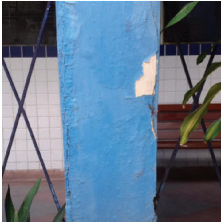
Figura 46 – Fissuras verticais na fachada frontal do bloco B
