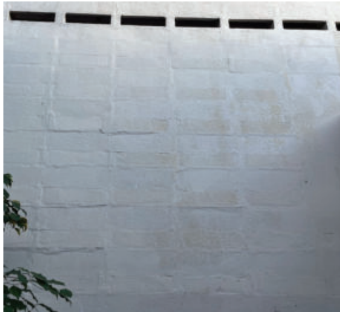
Figura 94 – Marcas na fachada lateral direita do bloco D
