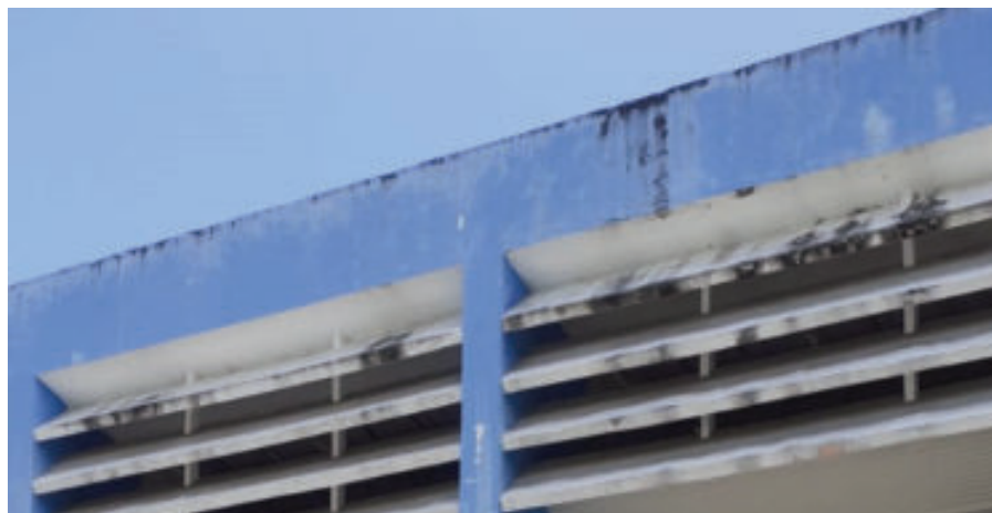
Figura 39 – Sujidade na parte superior da fachada frontal do bloco B
