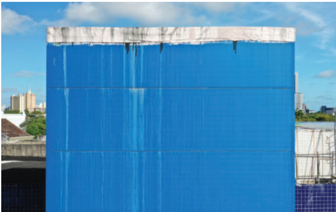
Figura 198 – Sujidade e eflorescência na caixa do elevador da fachada frontal dos blocos I e K
