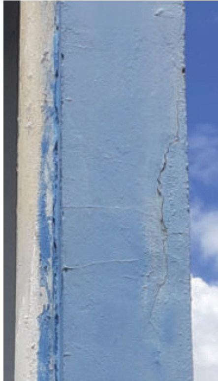
Figura 64 – Fissura vertical na fachada posterior do bloco B
