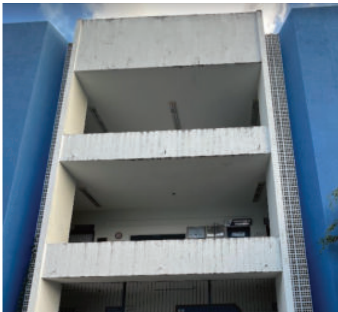
Figura 216 – Sujidade na fachada frontal do bloco J
