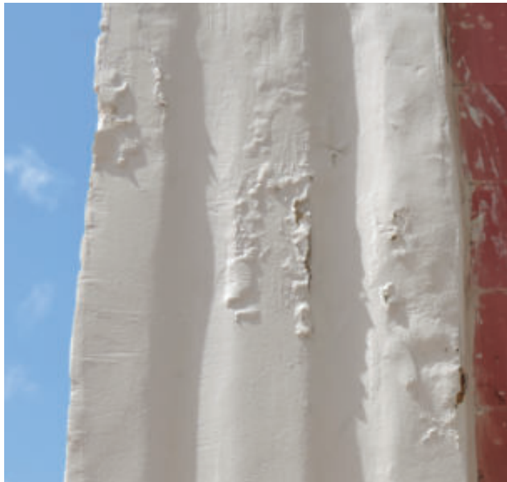
Figura 21 – Estufamento e desagregamento da argamassa na fachada frontal do bloco A
