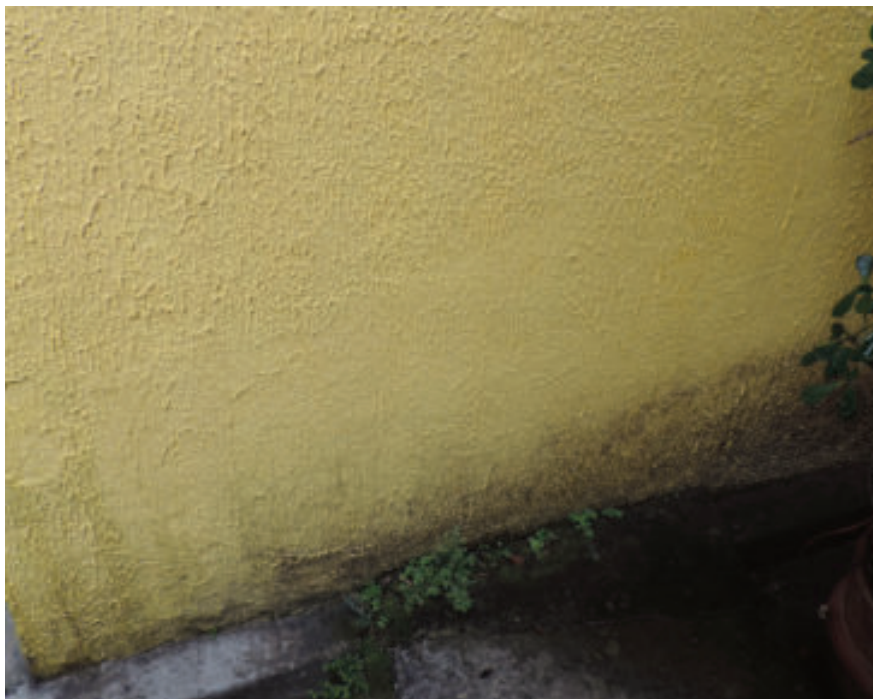
Figura 124 – Sujidade e vegetação na fachada posterior do bloco F
