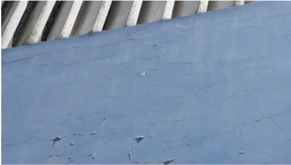
Figura 44 – Fissuras mapeadas na fachada frontal do bloco B
