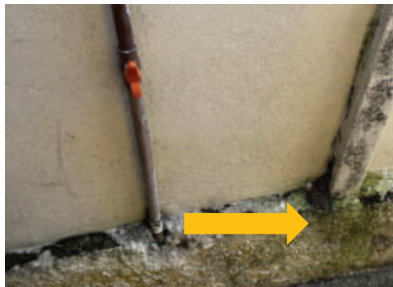
Figura 101 – Bolor na fachada posterior do bloco D
