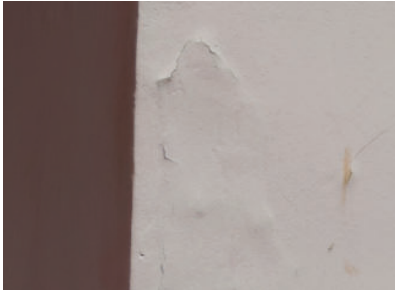
Figura 35 – Estufamento na fachada lateral esquerda do bloco A
