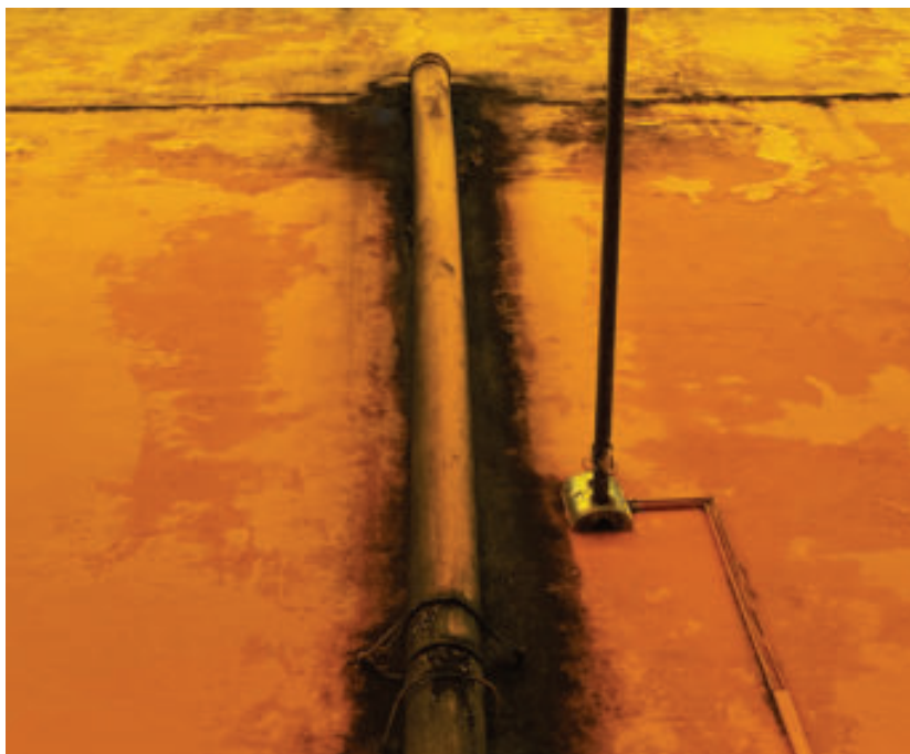
Figura 137 – Sujidade na fachada lateral direita do bloco G
