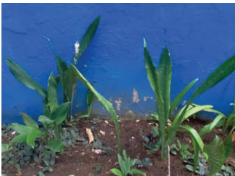
Figura 223 – Destacamento da pintura na fachada lateral esquerda do bloco J
