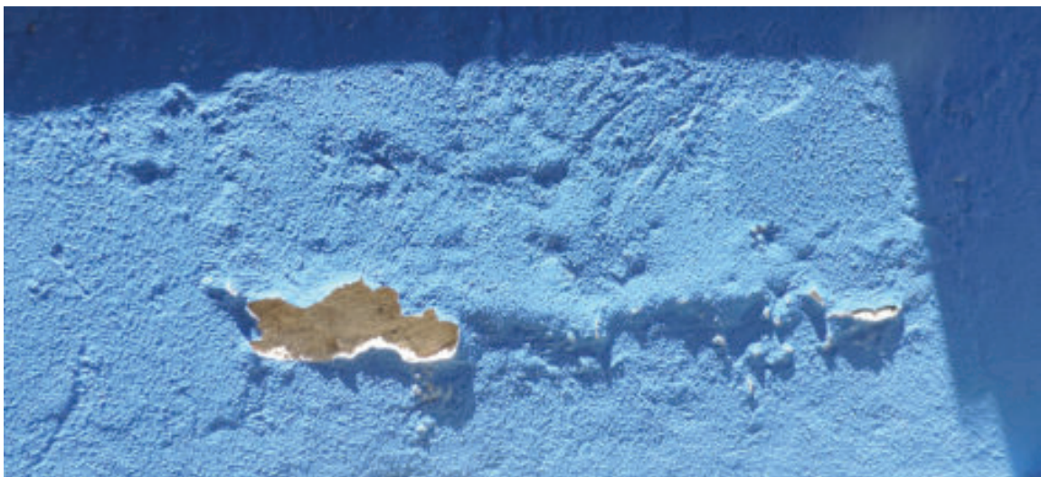
Figura 70 – Criptoflorescência com destacamento da pintura na fachada frontal do bloco C
