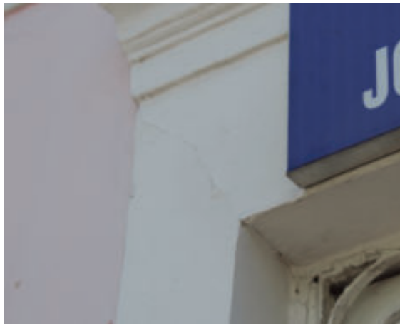
Figura 29 – Fissura 45° na fachada lateral direita do bloco A
