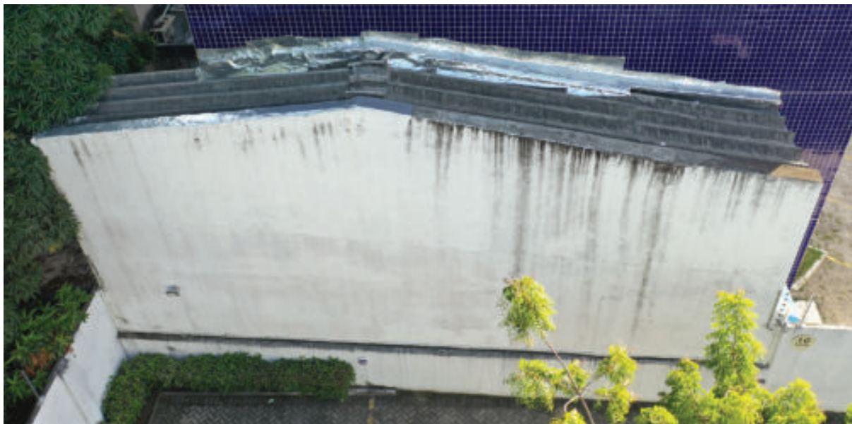
Figura 211 – Sujidade na fachada lateral esquerda dos blocos I e K
