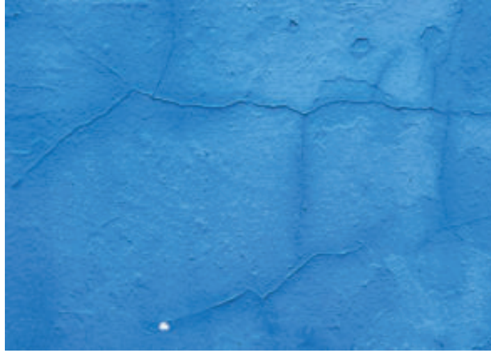
Figura 57 – Fissuras mapeadas na fachada lateral esquerda do bloco B
