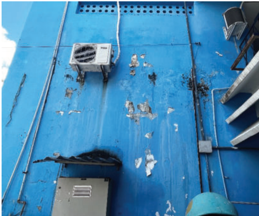
Figura 51 – Manifestações patológicas na lateral esquerda da fachada lateral direita do bloco B
