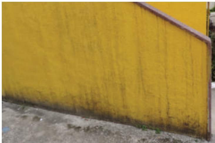
Figura 122 – Sujidade na base da fachada posterior do bloco F
