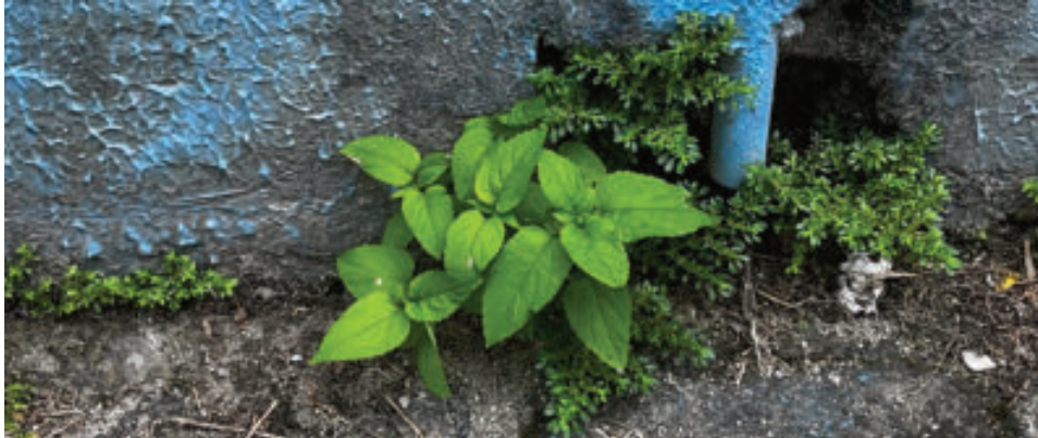
Figura 49 – Vegetação na fachada lateral direita do bloco B
