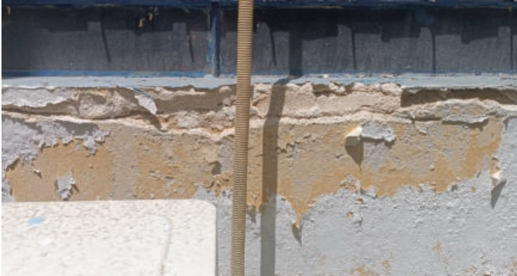
Figura 62 – Perda de reboco da fachada na fachada posterior do bloco B
