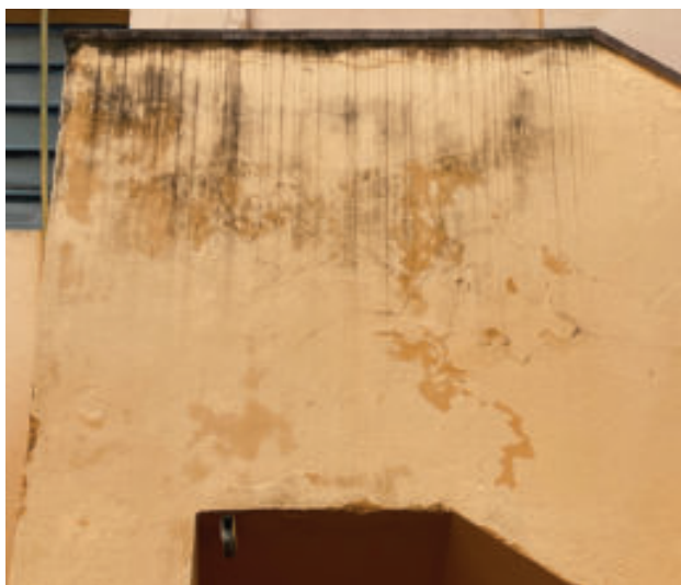
Figura 156 – Manifestações patológicas na fachada posterior do bloco G
