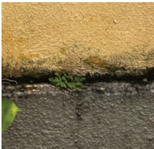
Figura 190 –Vegetação na fachada posterior do bloco H
