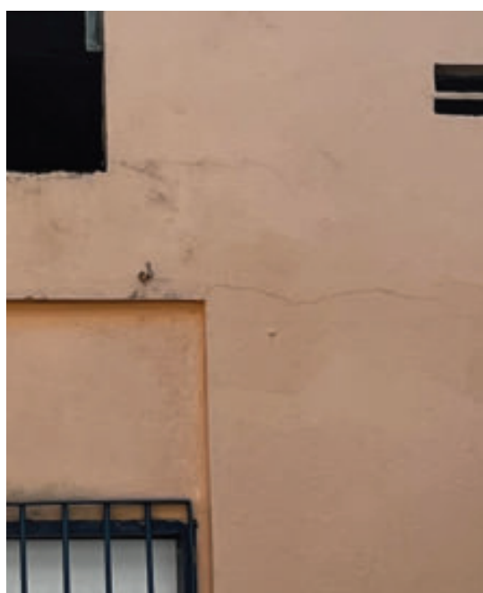
Figura 154 – Fissuras horizontais em extremidades de vãos na fachada posterior do bloco G
