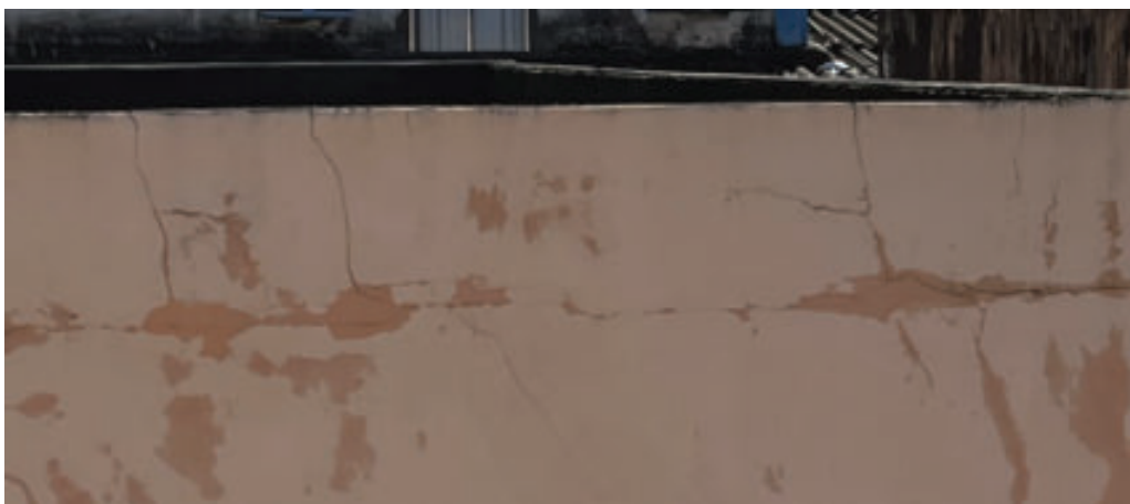
Figura 155 – Fissuras verticais e horizontais na platibanda da fachada posterior do bloco G
