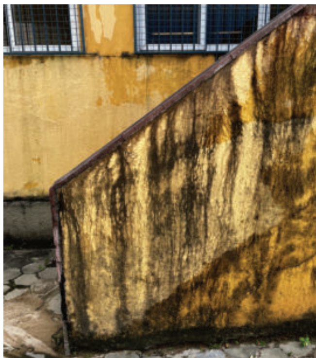
Figura 184 – Sujidade na parte externa da escada da fachada posterior do bloco H
