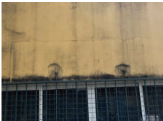
Figura 187 – Fissura horizontal e sujidade
