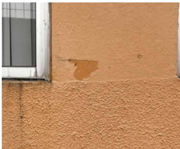
Figura 152 – Destacamento da pintura na fachada posterior do bloco G
