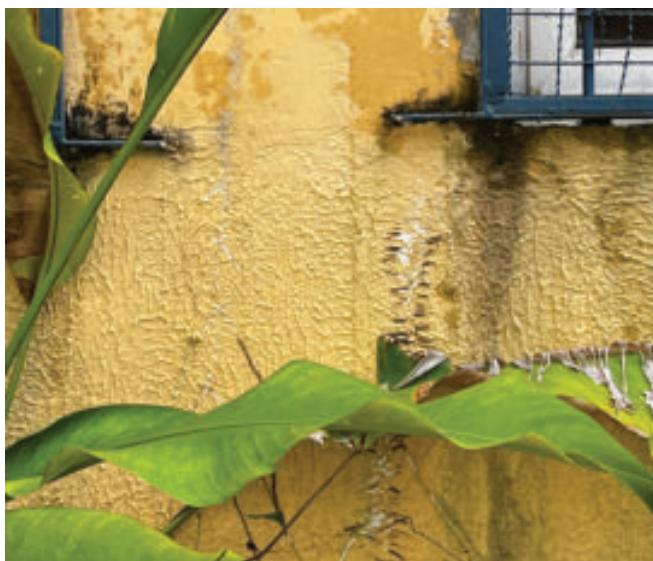
Figura 189 –Destacamento da pintura na fachada posterior do bloco H
