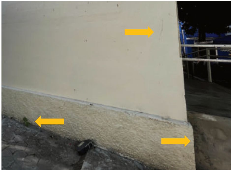
Figura 97 – Trinca, sujeidade e vegetação na fachada lateral esquerda do bloco D
