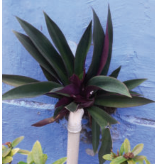
Figura 40 – Vegetação encontrada na fachada frontal do bloco B
