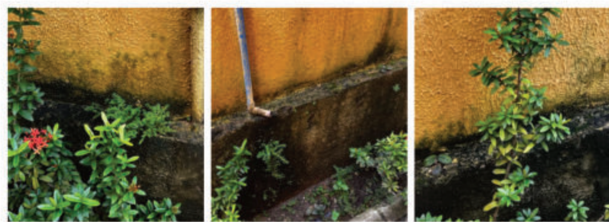
Figura 170 – Vegetação, mofo e bolor presentes na fachada lateral direita do bloco H
