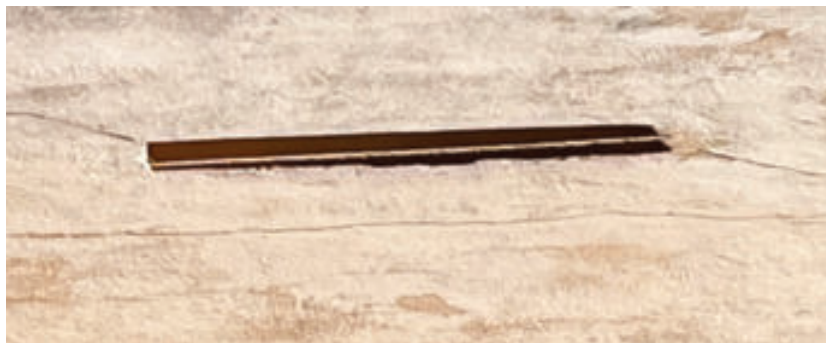
Figura 148 – Fissura 45° em abertura na fachada lateral esquerda do bloco G
