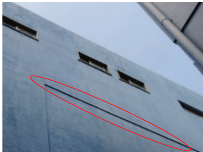
Figura 72 – Fissura horizontal na fachada frontal do bloco C
