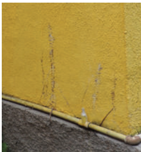
Figura 119 – Destacamento da pintura na fachada lateral esquerda do bloco F
