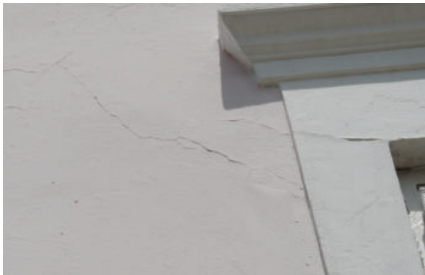
Figura 36 – Fissura 45° presente na fachada lateral esquerda do bloco A
