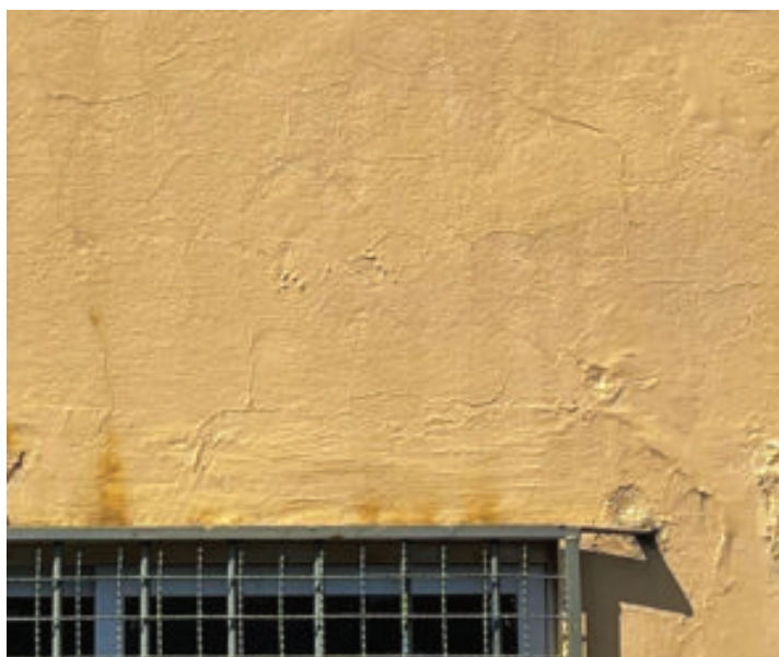
Figura 167 – Fissura mapeada na fachada frontal do bloco H
