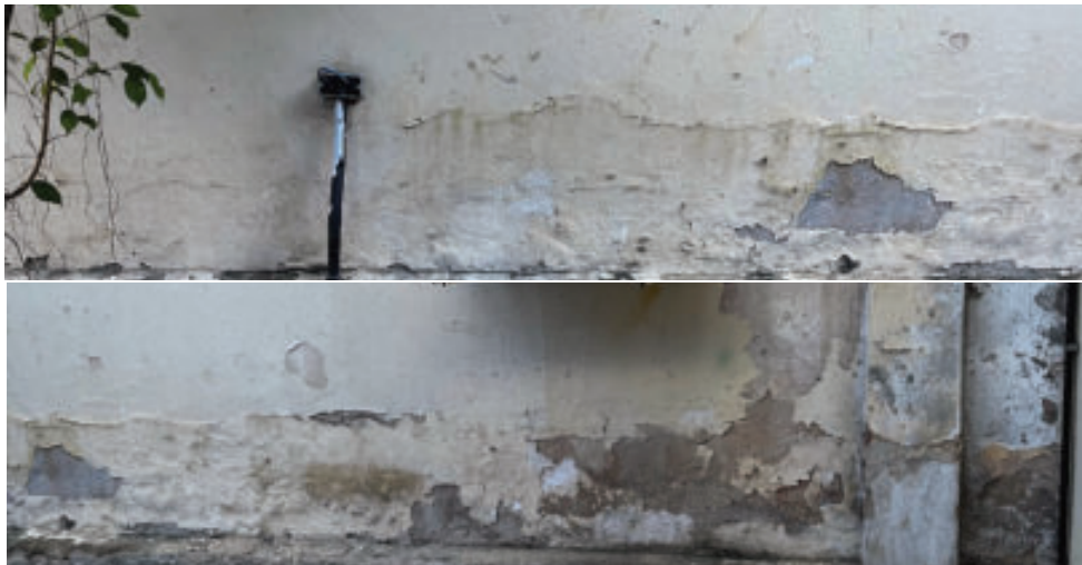
Figura 93 – Fissuras e destacamento da pintura da fachada lateral direita do bloco D
