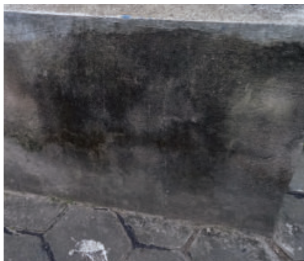
Figura 85 – Sujidade na rampa da fachada frontal do bloco D
