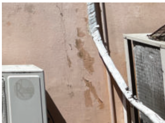
Figura 131 – Destacamento da pintura
