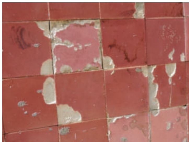
Figura 18 – Desagregação da cerâmica na fachada frontal do bloco A
