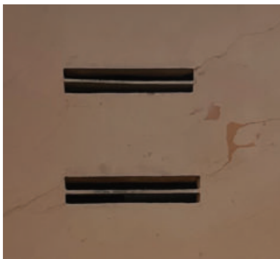
Figura 153 – Fissura 45° em abertura na fachada posterior do bloco G
