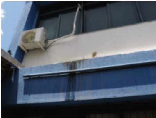
Figura 67 – Sujidade na fachada frontal
