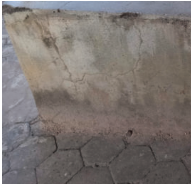
Figura 88 – Fissura mapeada na rampa da fachada frontal do bloco D
