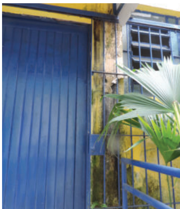
Figura 110 – Sujidade da fachada frontal do bloco F
