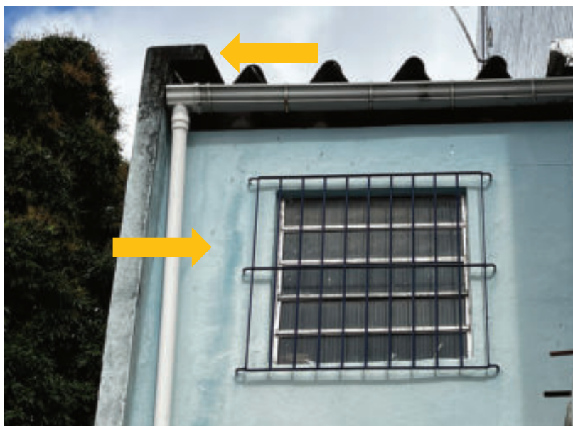
Figura 196 – Sujidade e manchas de umidade na fachada frontal dos blocos I e K
