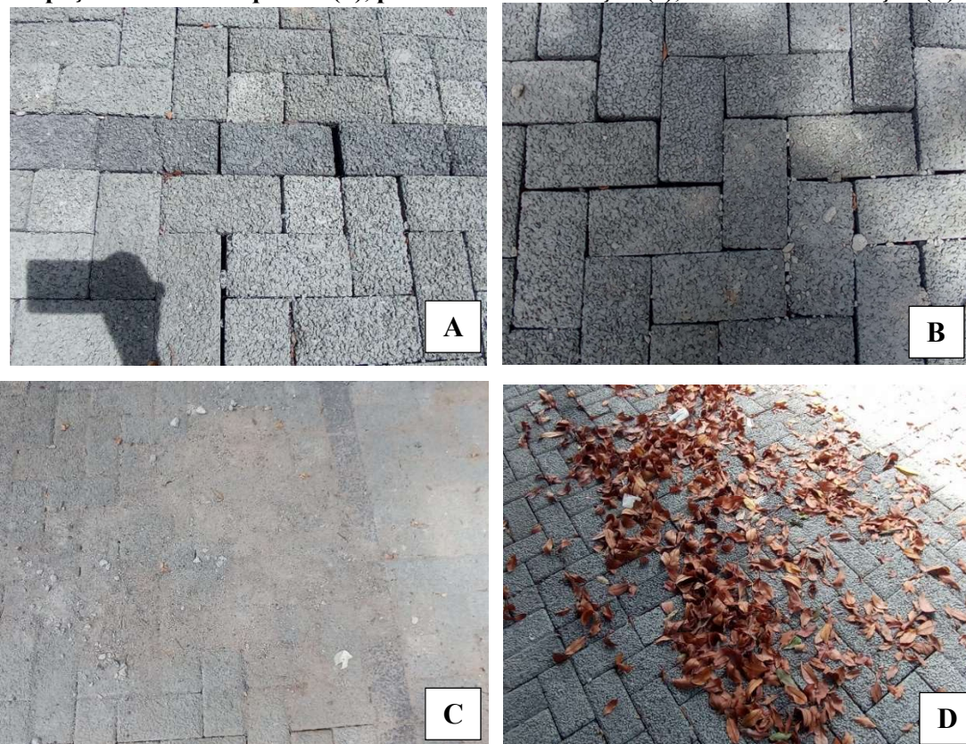
Figura 70 – Defeitos observados no pavimento devido à execução ou manutenção. Desníveis (a), espaçamentos inadequados (b), processo de colmatção (c), ausência de varrição (d)
