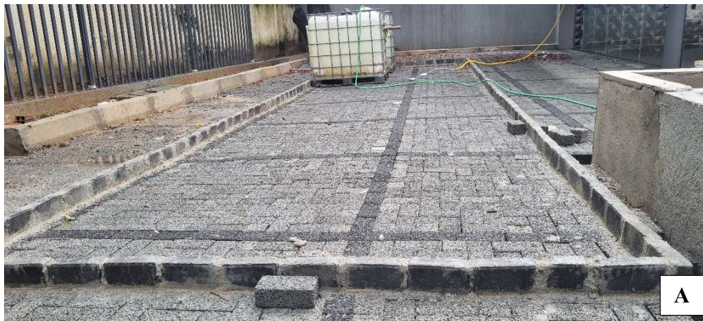
Figura 42 – Área dos ensaios de simulação hidráulica. Área total do módulo experimental com 27m 2 (a), área reduzida com 9,45m 2 (b)
