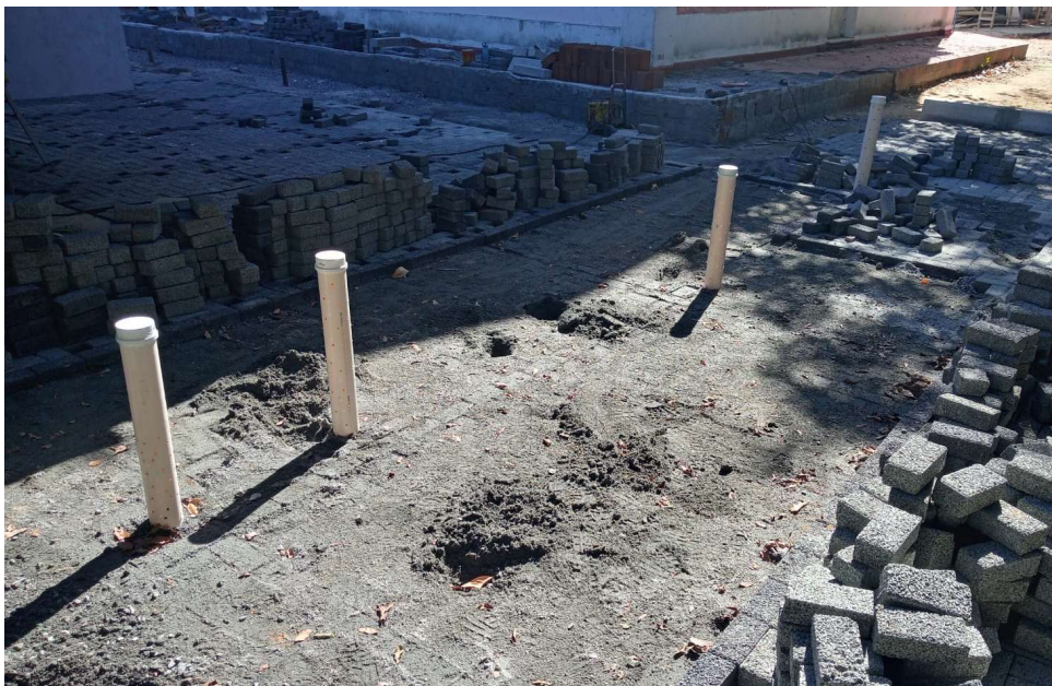
Figura 39 - Piezômetros instalados na área do módulo experimental
