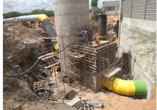
Foto 6 - Interligação na chaminé de equilíbrio
