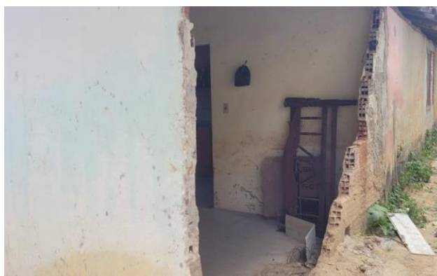
Figura 14: Desabamento parcial em imóvel no inverno de 2021.
