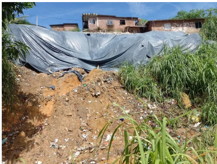
Figura 13: Deslizamento de uma encosta em Maio de 2022 na área de estudo.
