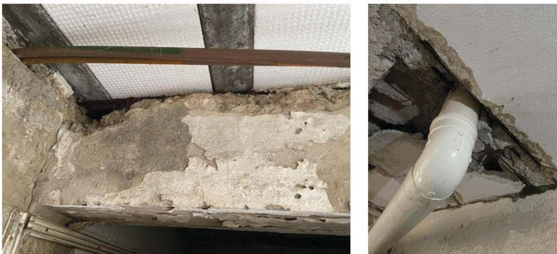
Figura 20 – (a) viga com armadura exposta e apoio de laje inadequado (b) furo em viga em região inadequada
