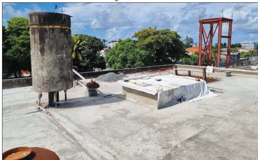
Figura 40 – Contrapiso da laje, com os caimentos adequados para funcionamento do sistema de drenagem, executado
