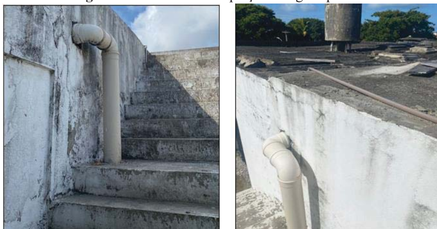
Figura 38 – Sistema de captação de águas pluviais.
