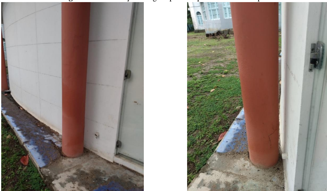
Figura 40 - Destinação de águas pluviais próxima à base de pilar
