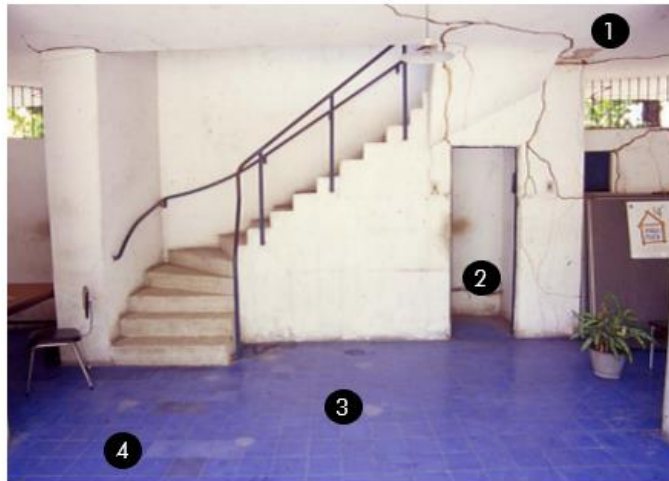
Figura 28 - Manifestações patológicas presentes no pavimento térreo antes da restauração (2002)
