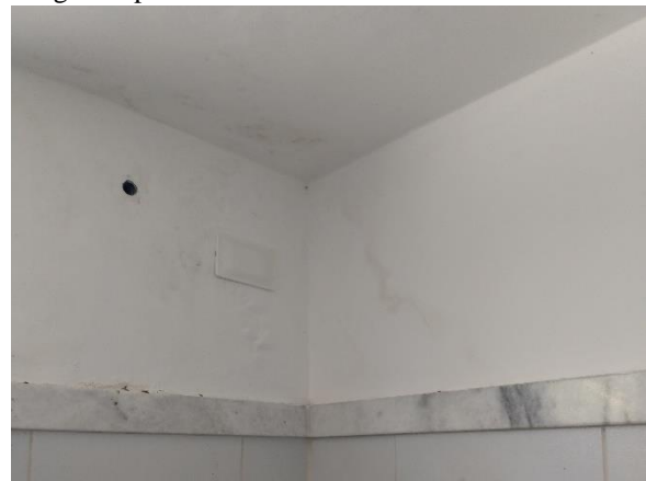
[b] Mancha de infiltração no banheiro
