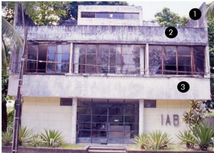
Figura 29 - Tipos de manchamentos presentes na fachada leste antes da restauração (2002)
