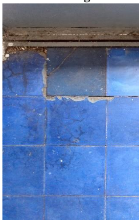
[a] Ladrilho hidráulico
