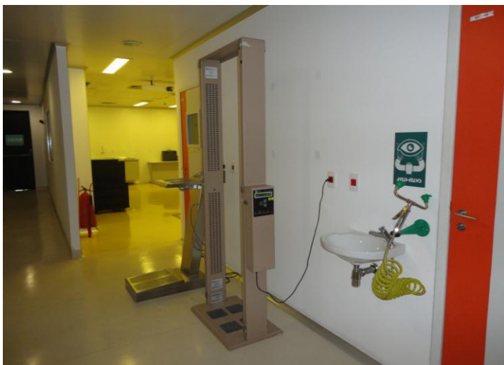
Figura 8.5 – Equipamentos de proteção coletiva
