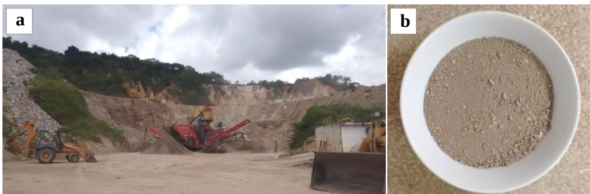
Figura 20 – Vista geral da usina de reciclagem, em Outubro de 2016 (a), e agregado miúdo de RCD reciclado (sem escala) (b).
